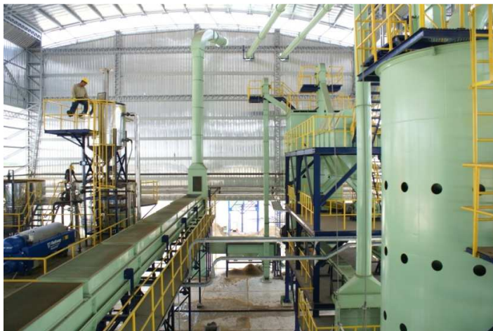
Figura 7. Planta extractora fabricada por Industrias AVM
