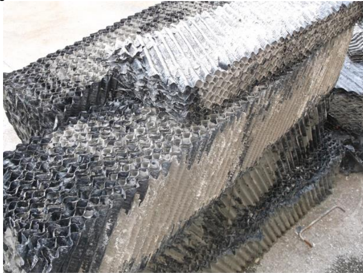
Figura 125. Cambio de relleno fílmico – Torre de enfriamiento
