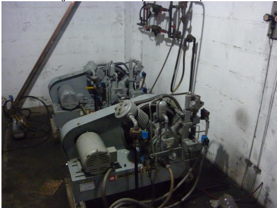
Figura 55. Unidades compresoras de alta presión
