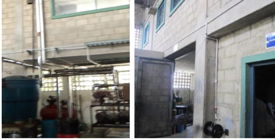
Figura 47. Red de aire comprimido de PVC
