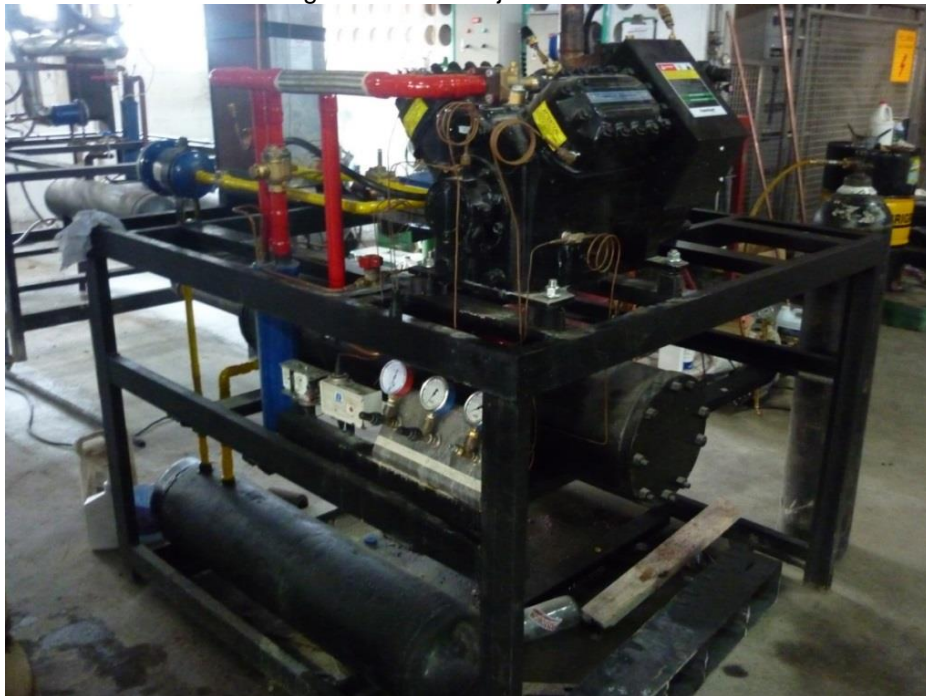
Figura 118. Montaje final Chiller
