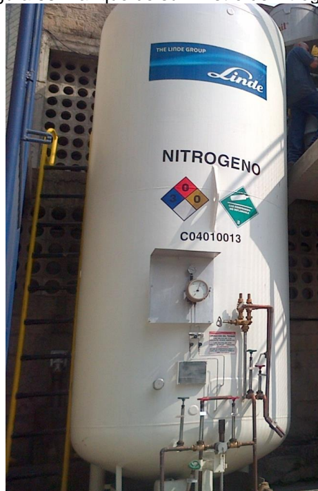
Figura 53. Tanque de suministro de nitrógeno
