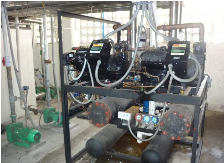
Figura 121. Instalación final del chiller
