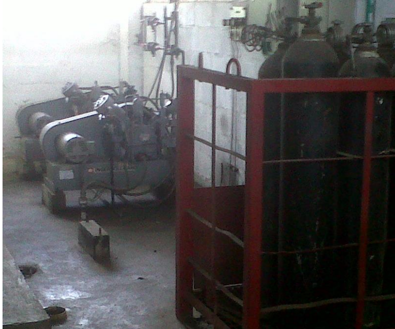
Figura 56. Sistema de Suministro de Nitrógeno
