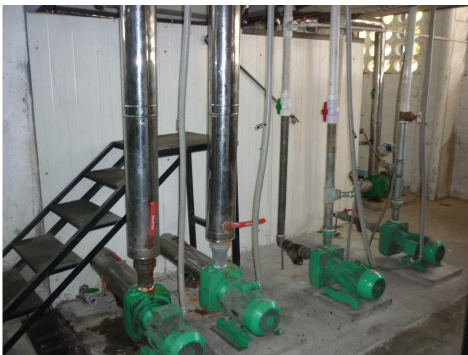
Figura 120. Instalación final Tanque y Bombas de agua
