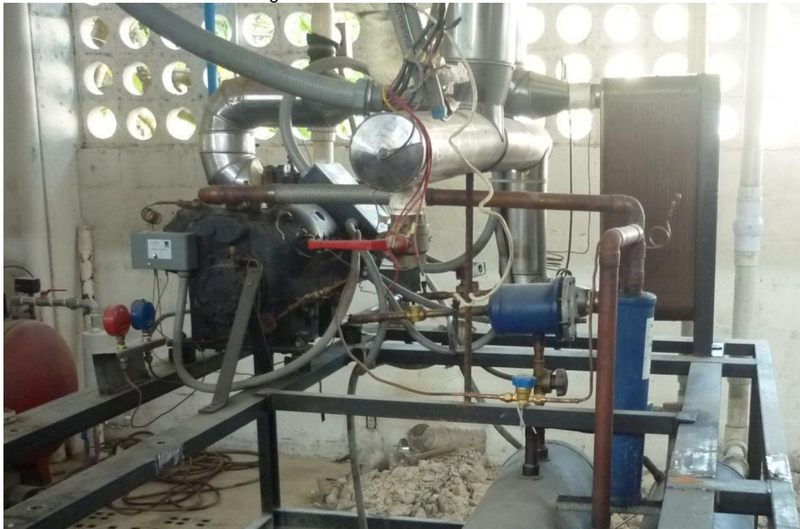
Figura 50. Chiller en funcionamiento
