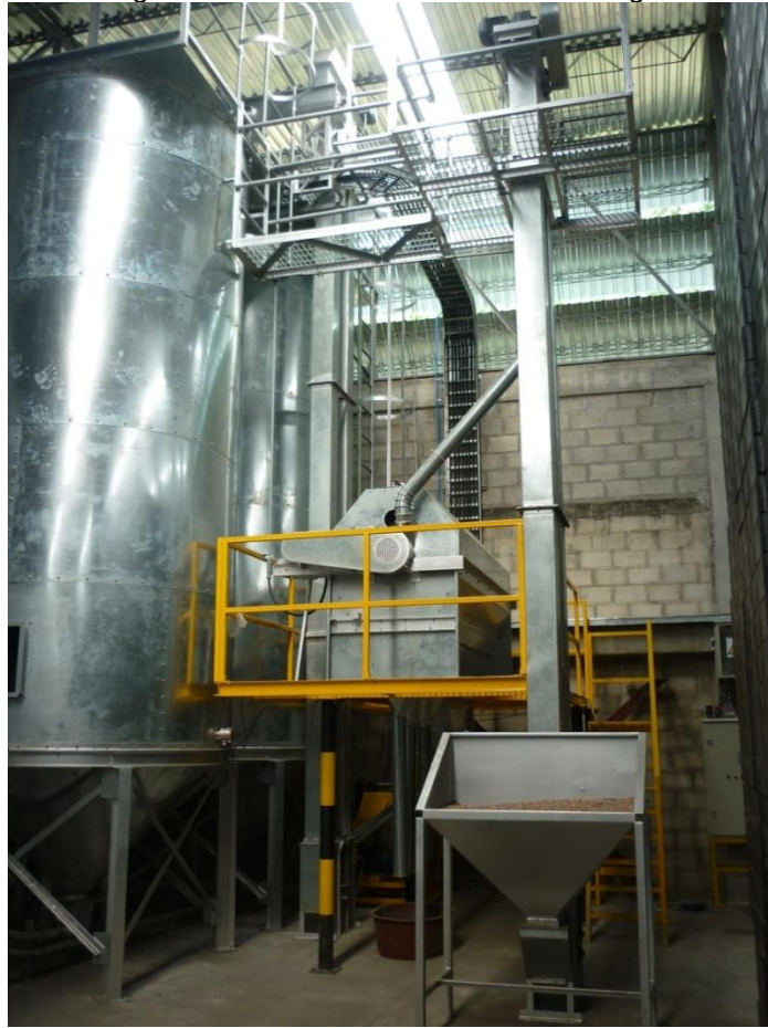
Figura 147. Estado Final sistema de cargue
