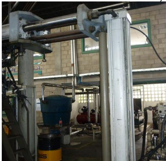
Figura 40. Acumulador Hidráulico del sistema de inyección
