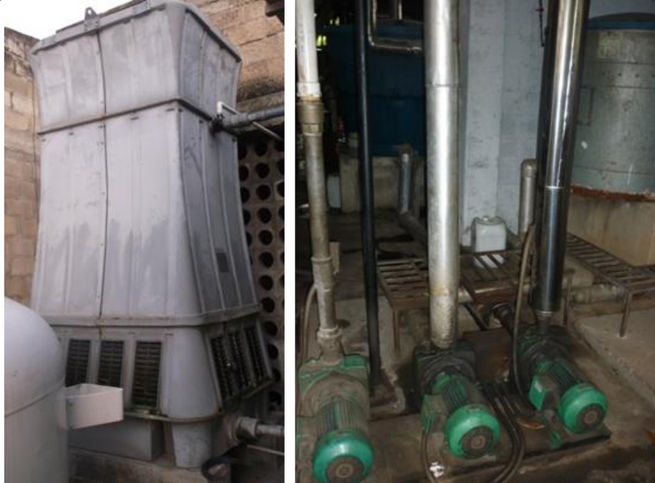
Figura 51. Torre de enfriamiento y sistema de recirculación del agua de refrigeración
