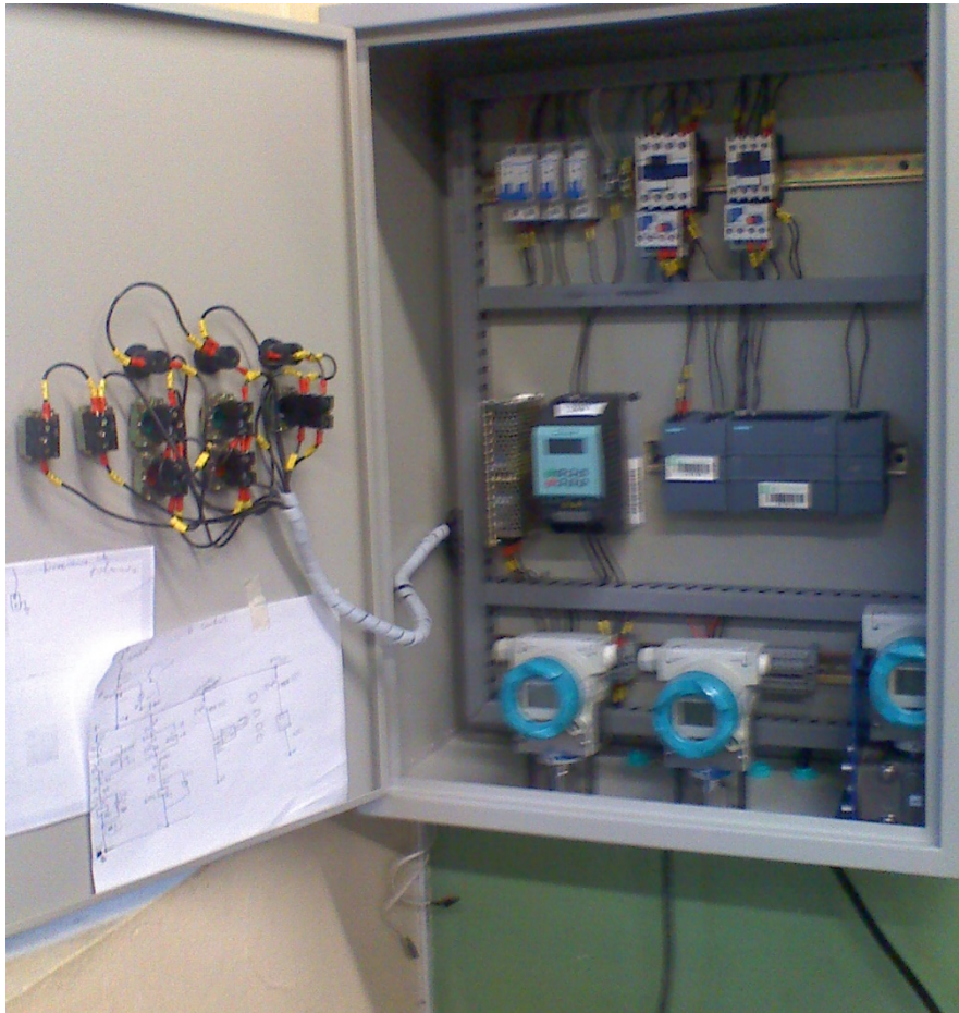
Figura 33. Disposición final tablero de control
