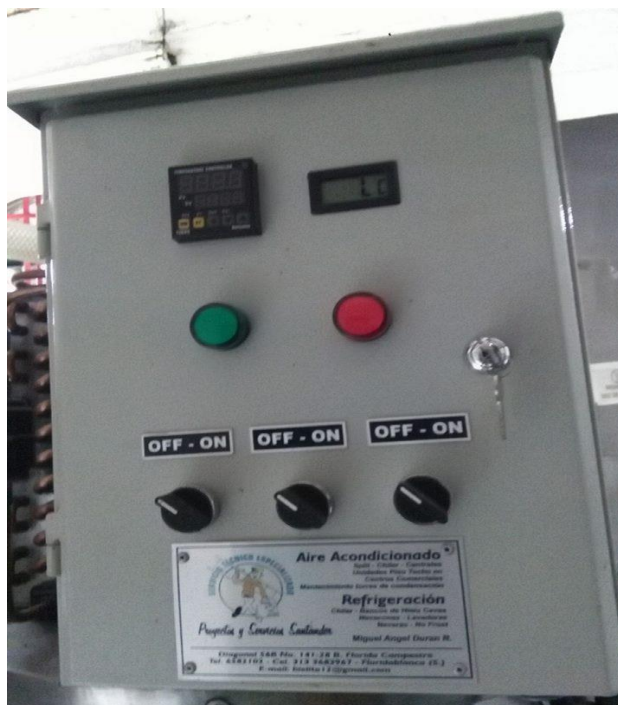
Figura 11. Gabinete de control del fermentador con controlador TZN4S.
