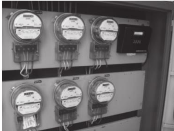
Figura 5. Armario de medidores, [3]
