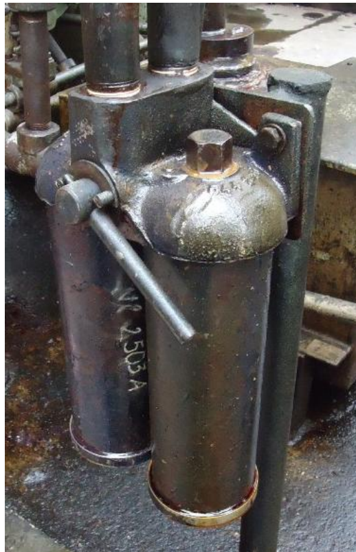
Figura 40. Filtros Sistema de Lubricación.
