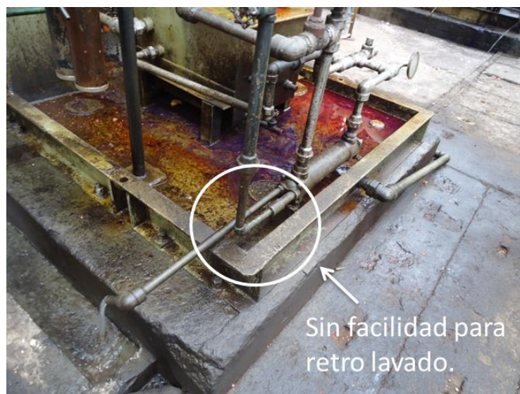
Figura 54. Enfriador Sistema P2503B.
