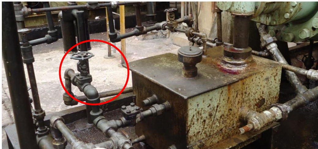
Figura 58. Línea de la Válvula de Alivio de Presión.
