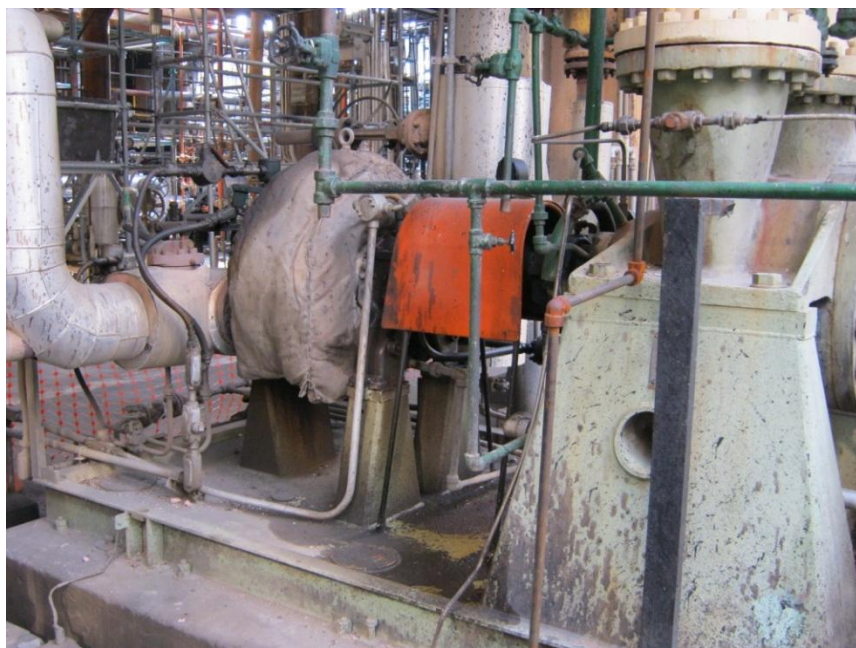
Figura 12. Sistema de Bombeo SP2503B.
