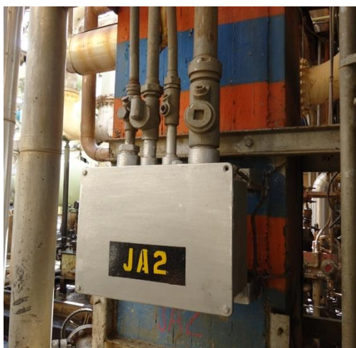
Figura 85. Caja de Conexiones JA-02.
