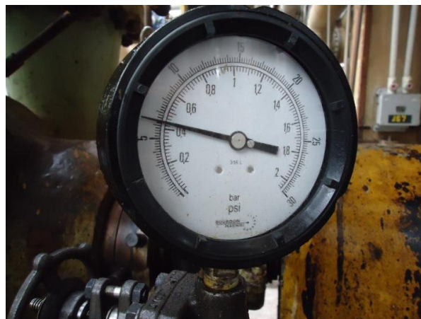
Figura 45. PI a la entrada de la caja de chumacera lado acople de la bomba.
