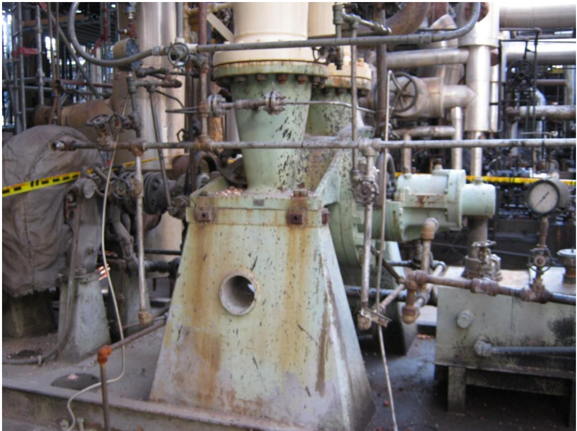
Figura 11. Sistema de bombeo SP2503A.
