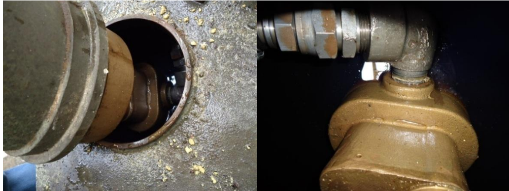
Figura 51. Bomba Incorporada al Interior de la Consola de Lubricación.
