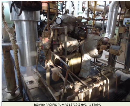
BOMBA PACIFIC PUMPS 12*19 S HVC - 1 ETAPA
