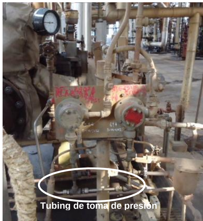
Figura 84. Switchs de Presión en el SP2503A/B/C.
