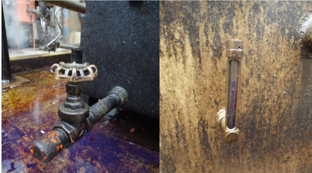
Figura 57. Conexiones de Drenaje del Tanque e Indicador de Nivel de Aceite.
