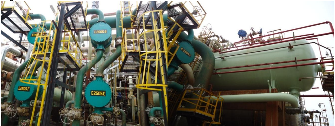
Figura 5. Tambor de Solvente de Alta Presión D-2505 e Intercambiadores E-2505.
