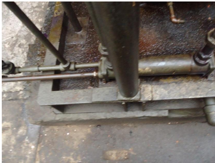
Figura 53. Enfriador Sistema P2503A.
