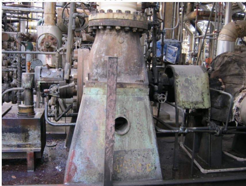
Figura 13. Sistema de Bombeo SP2503C.
