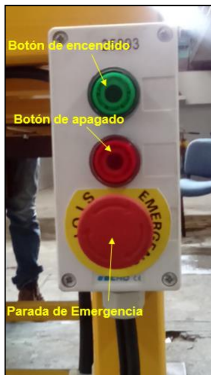
Figura 80. Caja de Encendido/Apagado del banco
