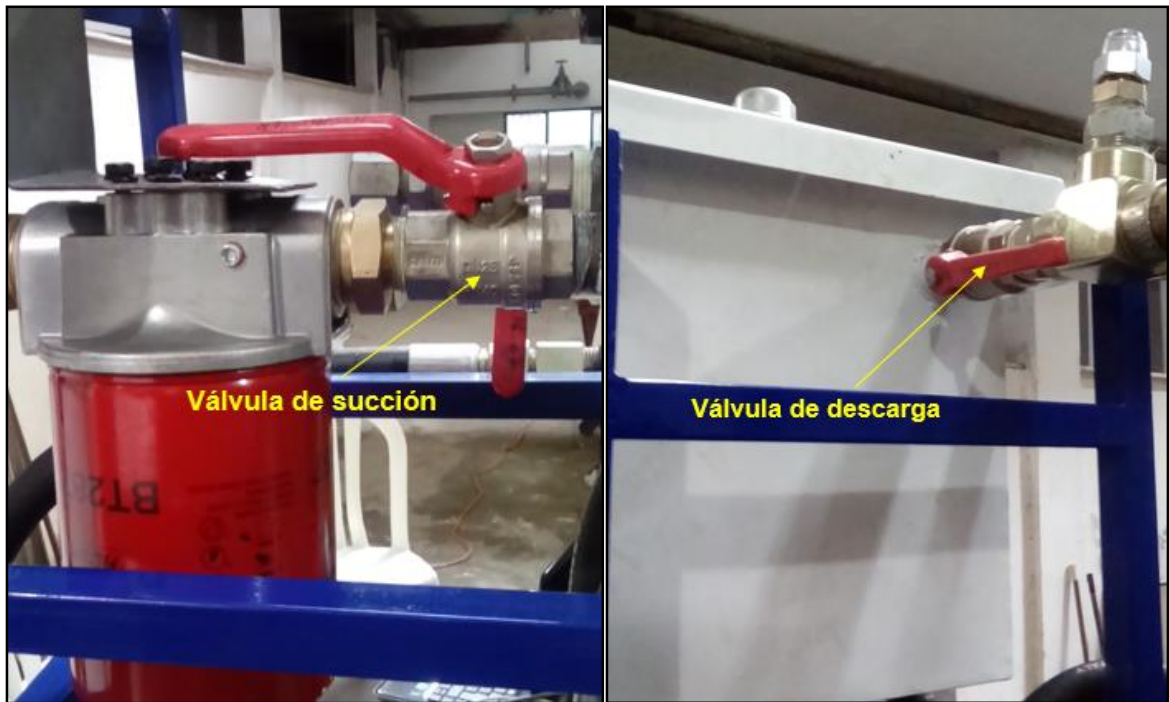
Figura 79. Válvulas de succión y descarga de la bomba
