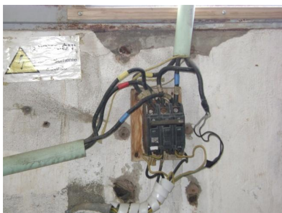
Figura A-10 Instalaciones eléctricas deterioradas en funcionamiento.
