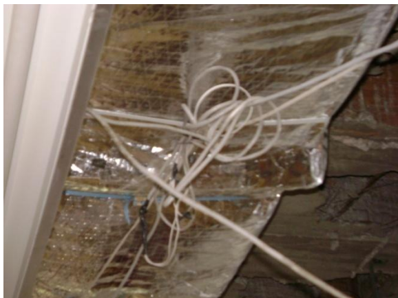
Figura A-8 Instalaciones eléctricas enredadas.
