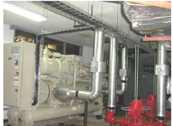
Figura A-19 Aire acondicionado
