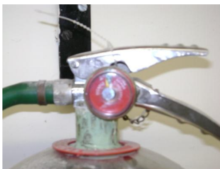
Figura A-14 Extintor con baja carga
