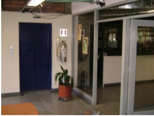
Figura A-15 Extintor detrás de la matera , no se puede ver a simple vista.
