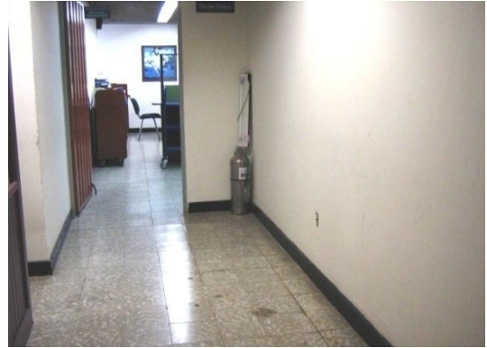
Figura A-17 Extintor sosteniendo una lámpara
