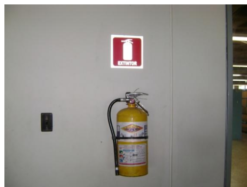
FiguraA-11 Señalización para identificar extintores
