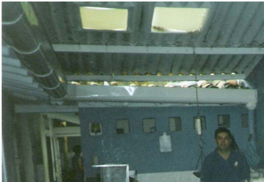
Area de despacho
