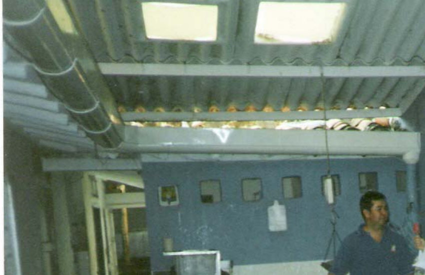
Area de despacho
