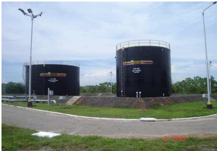
Figura 35. Tanques de almacenamiento.
