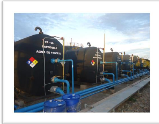
Figura 4. Tanques de almacenamiento de agua PIA Cohembí 1.
