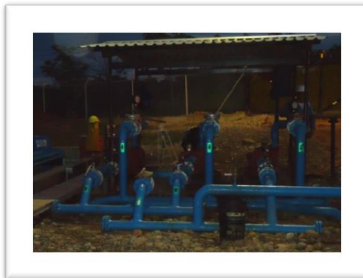
Figura 3. Bombas de descargue de agua PIA Cohembí 1.
