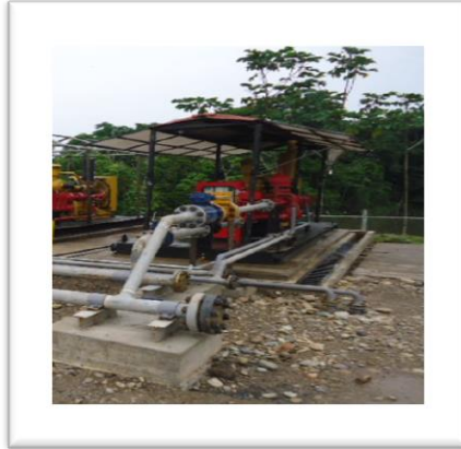
Figura 9. Bombas de Inyección de Agua PIA Cohembí 1.
