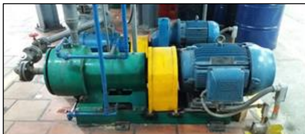
Figura 4. Planta de Producción Grasas PROQUIMSA S.A.S. - Sistema de motor - Molino.
