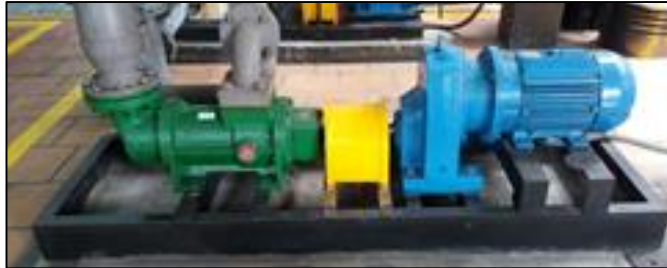
Figura 3. Planta de Producción Grasas PROQUIMSA S.A.S. - Sistema de motor - bomba.
