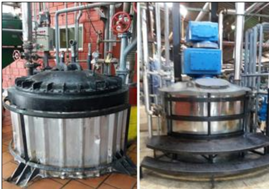
Figura 2. Planta de Producción Grasas PROQUIMSA S.A.S. - Reactor y Sistema Mezclador.
