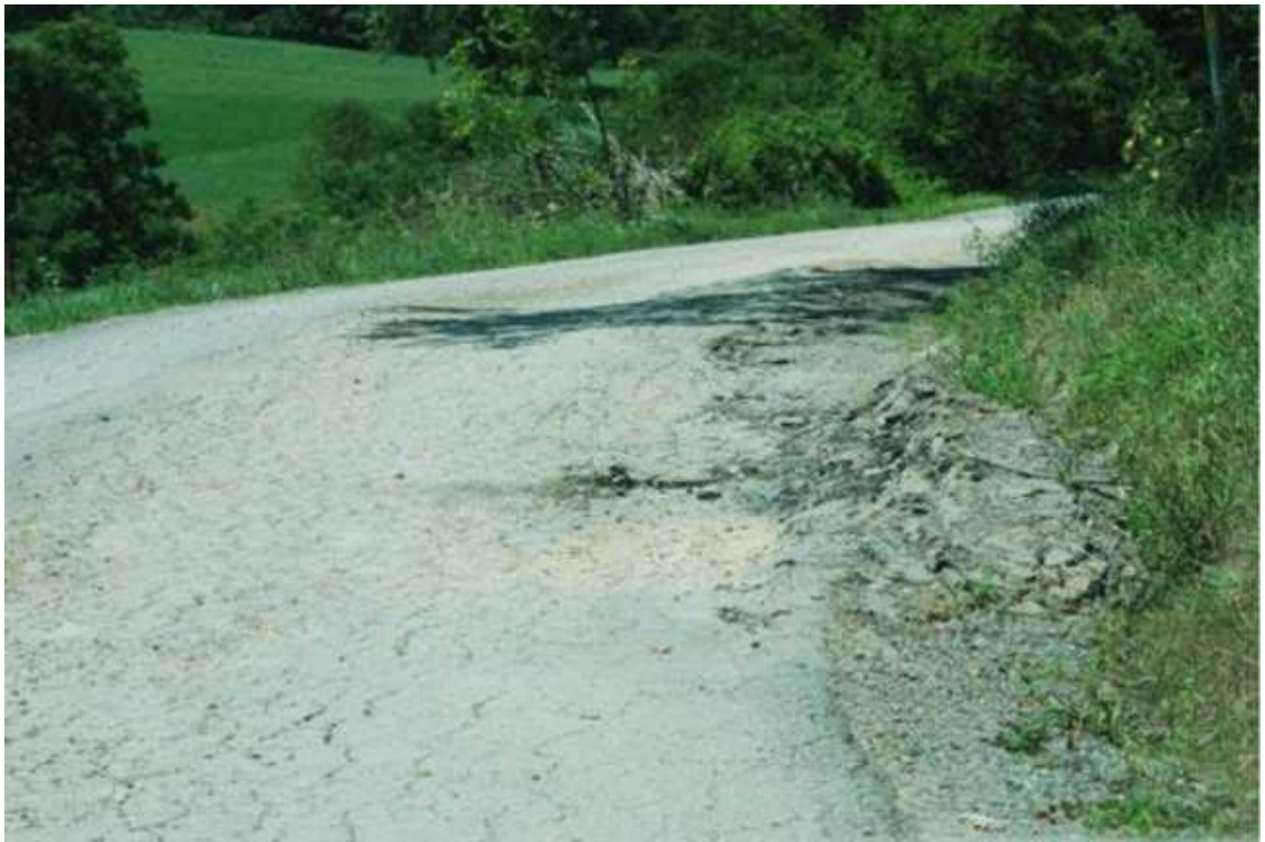
Figura 7. Daño de la carretera en Pennsylvania, Estados Unidos
