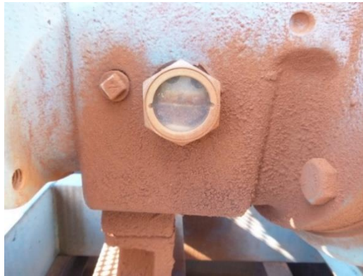
Ilustración 15. Zona de presencia de suciedad, bomba retrolavado.
