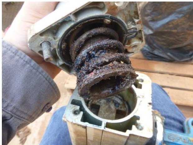
Ilustración 17. Suciedad en la recamara neumática de los actuadores.
