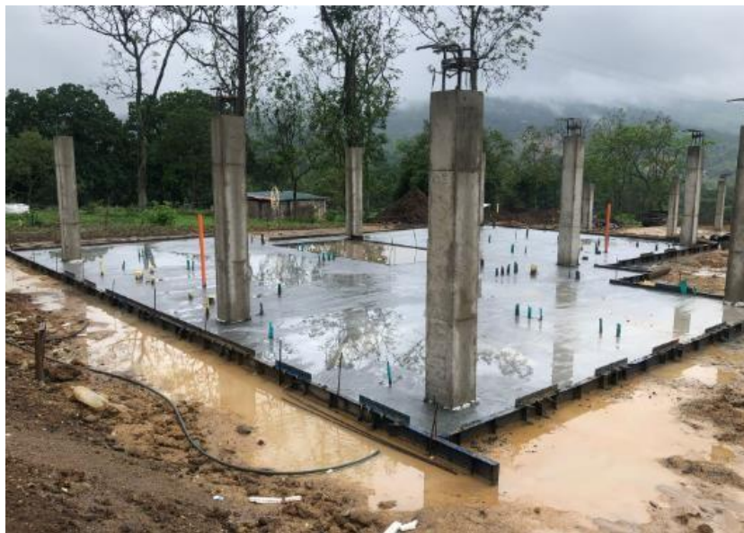
Figura 18. Acumulación de agua debido a lluvias intensas
