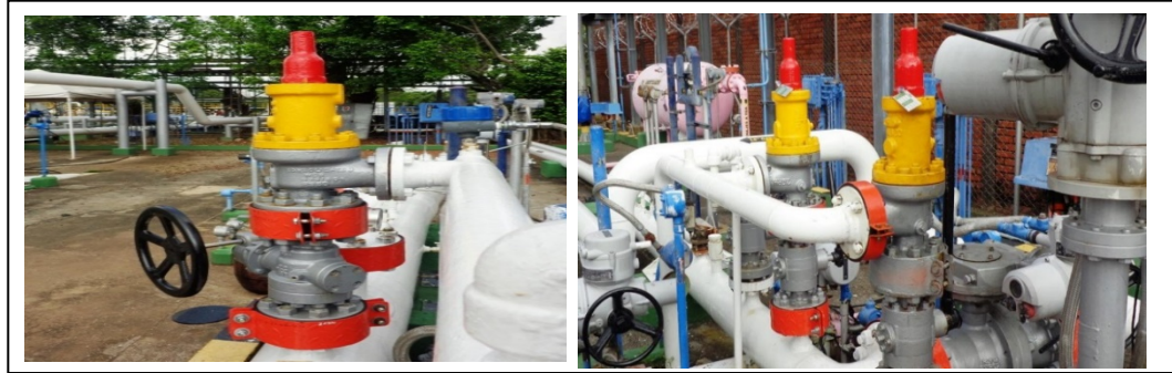
Figura 9 Válvulas de alivio de la estación
