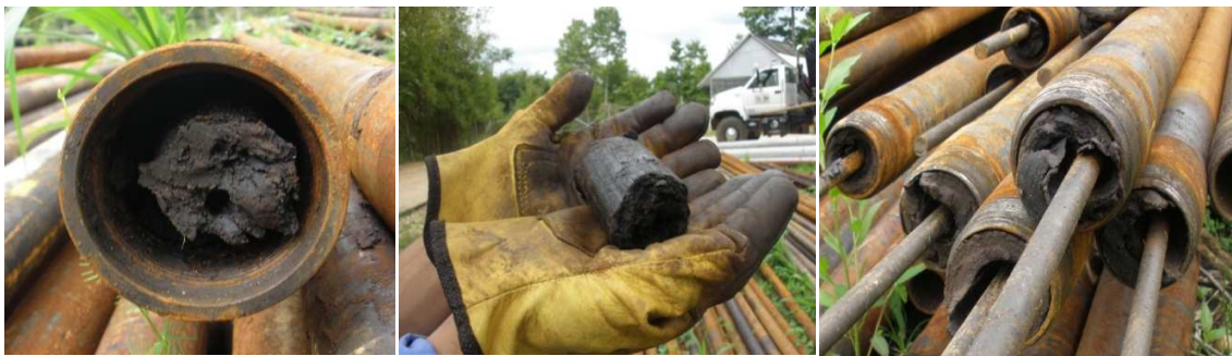
Figura 5. Parafina depositada en la tubería de producción.
