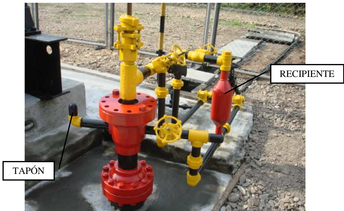
Figura 15. Sistema de recirculación de químicos, indicando el recipiente y la línea que despresuriza el anular.
