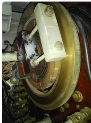
Figura 8. Taps del transformador T2
