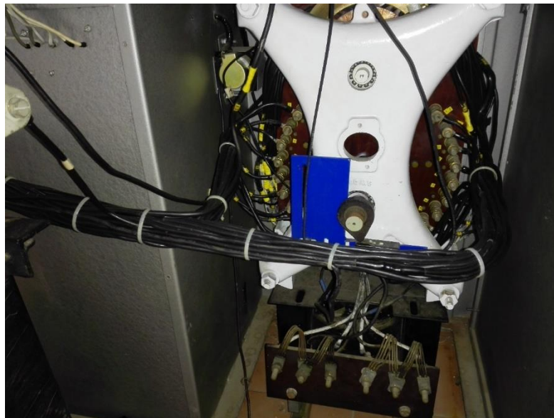
Figura 40. Organización y limpieza de los conductores que van a los taps
