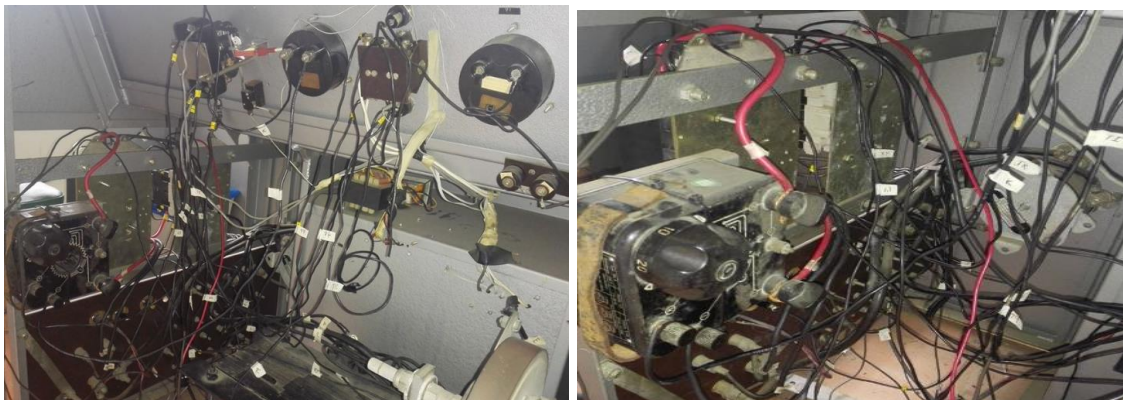
Figura 33. Evidencia del cableado
