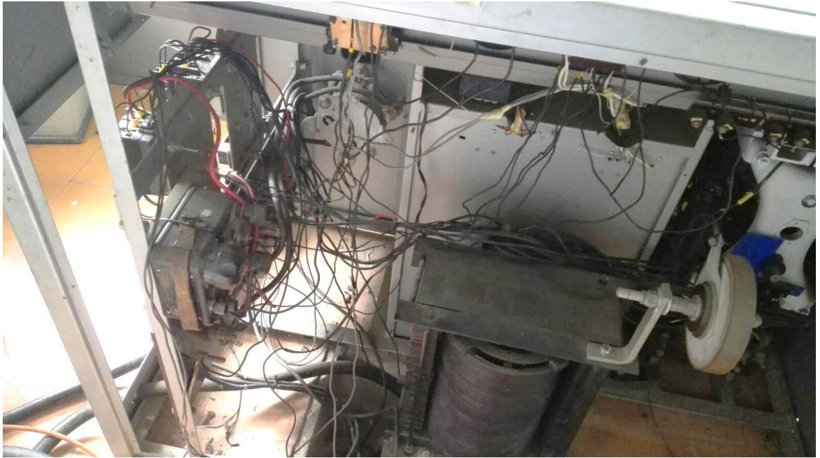
Figura 35. Consola de corriente alterna antes del cambio de cableado
