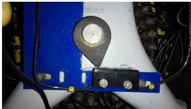
Figura 15. Inicio de carrera cerrado (manivela en cero volts)
