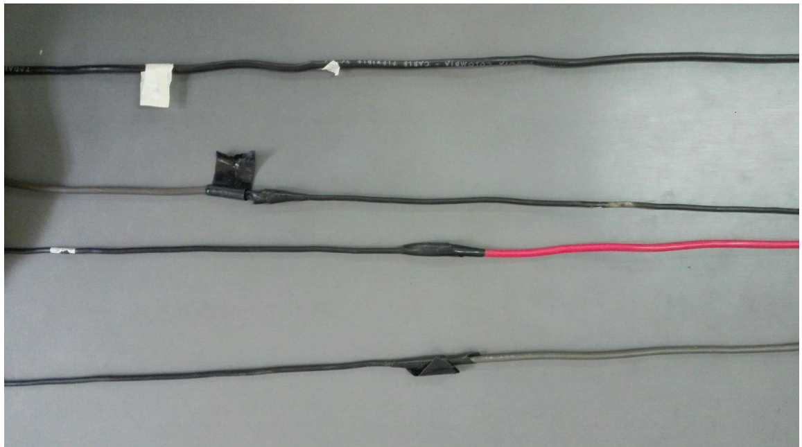
Figura 36. Estado de algunos de los conductores antes del cambio de cableado
