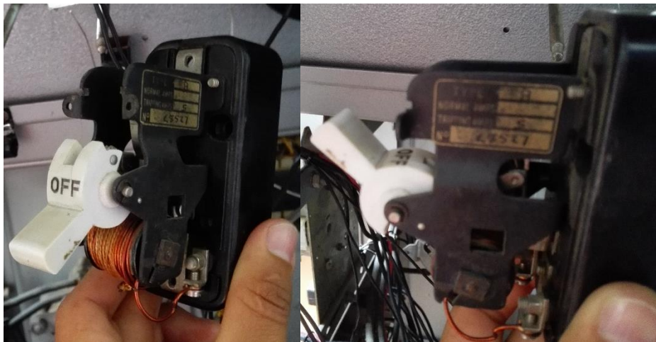
Figura 44. Interruptor de alta tensión
