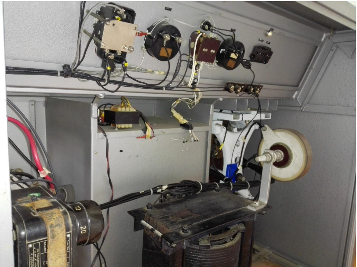
Figura 37. Consola de corriente alterna después del cambio de cableado
