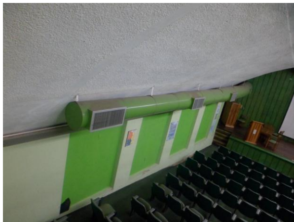
Figura 62. Ducto y difusores del sistema de aire acondicionado en el auditorio
