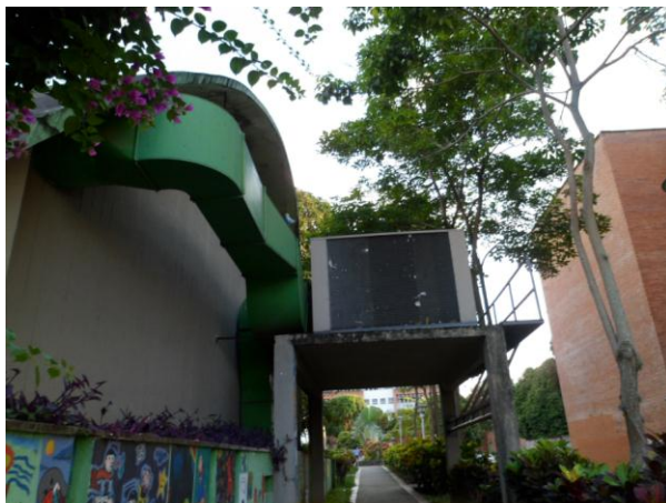
Figura 61. Unidad del aire acondicionado
