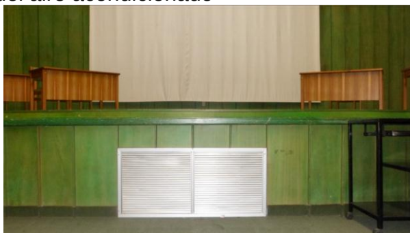
Figura 63. Retorno del aire acondicionado
