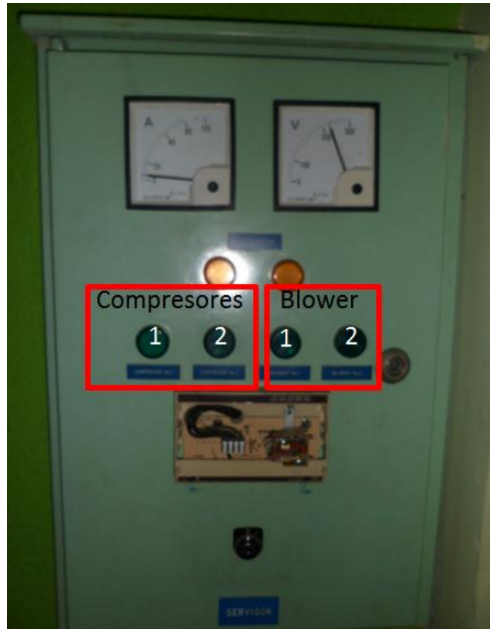
Figura 54. Panel de control del aire acondicionado
