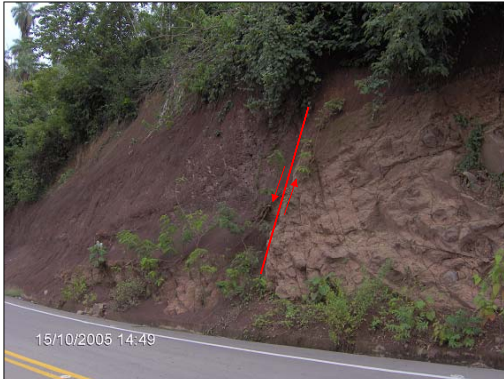
FIGURA 43. Falla normal que corta la Unidad Volcanoclástica de Noreán en el bloque colgante de la falla Simití. Este proceso es compensado en el bloque yacente en una estructura sinclinal a manera de un pliegue de arrastre que afecta las rocas Cretácicas.
