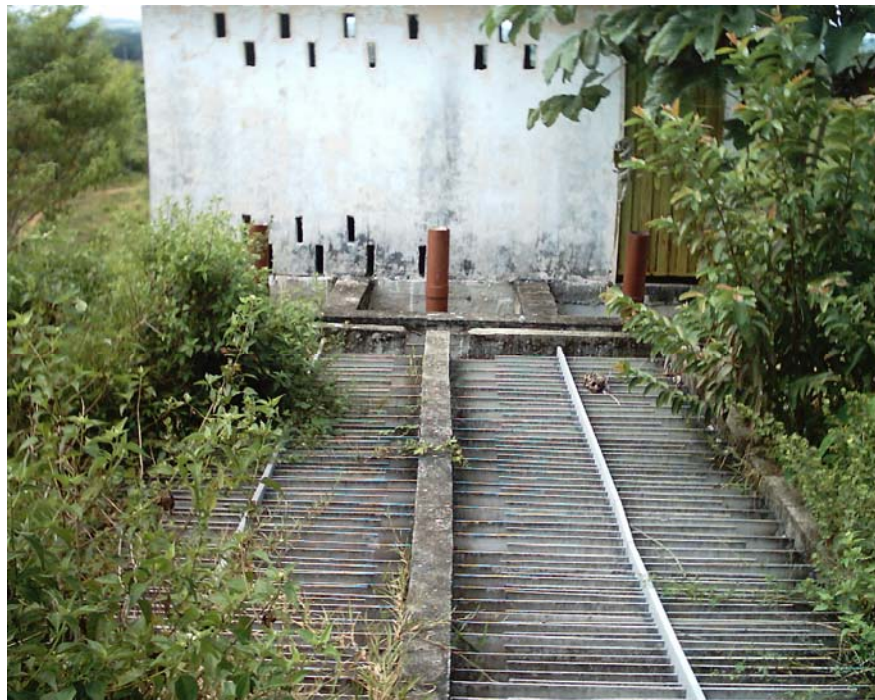
Floculador de placas paralelas verticales
