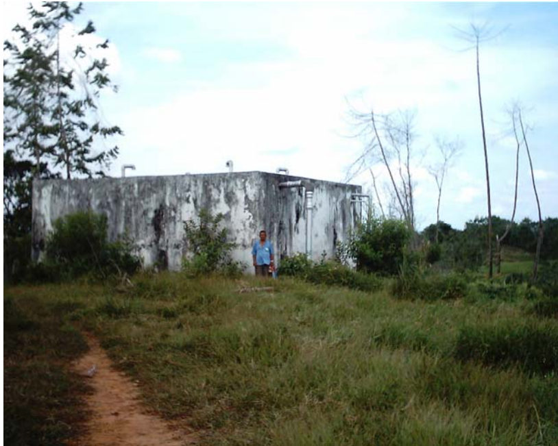
Tanque de almacenamiento
