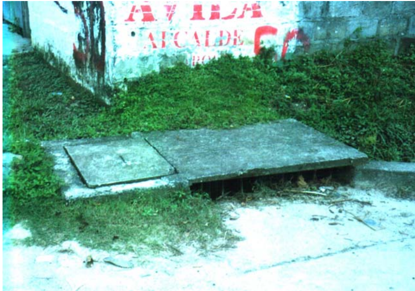
Mal estado de sumidero (calle 7 con carrera 7)
