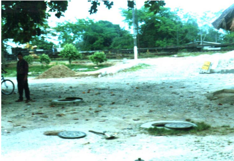
Problema de los tres pozos en la esquina de la calle 9
