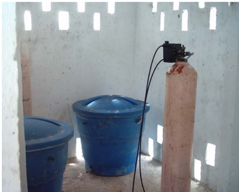
Dosificador de Cloro Gaseoso
