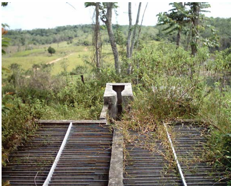
Entrada Planta de tratamiento de agua potable
