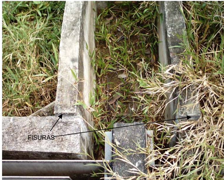
Fisuras a La Entrada Del Floculador
