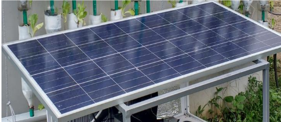
Figura 46. Panel solar YINGLI 135 [W]
