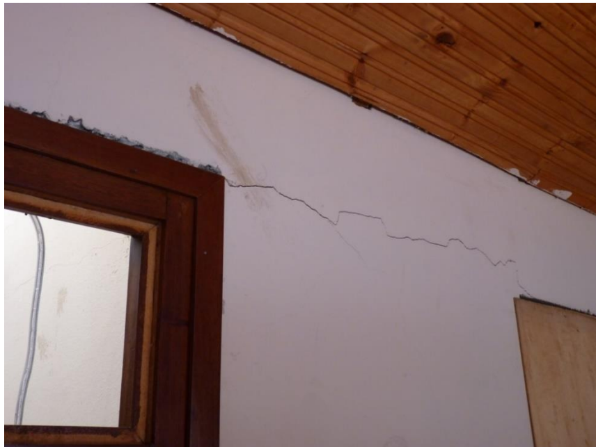
Figura 3-44. Grietas en paredes.
