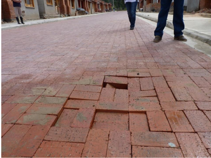
Figura 3-43. Hundimiento del piso.
