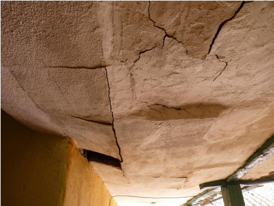
Figura 3-42. Grietas en techos.
