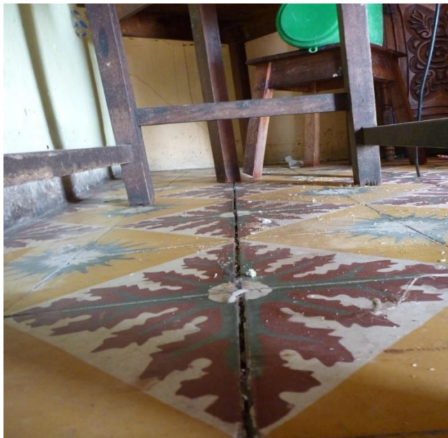
Figura 3-46. Grietas en pisos.
