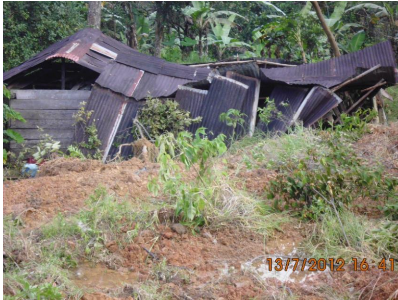
Figura 3-32. Daños en viviendas.
