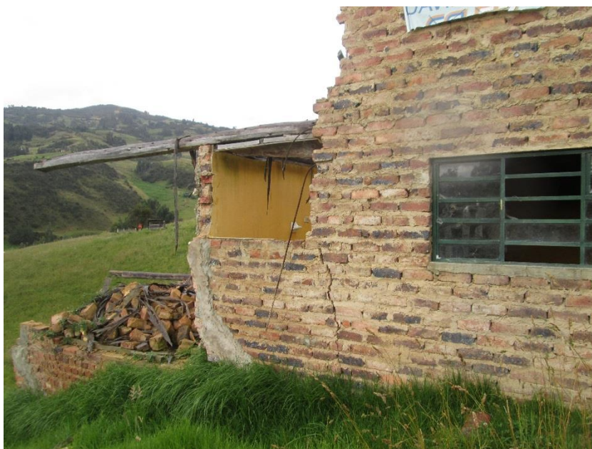
Figura 3-38. Impactos en viviendas.
