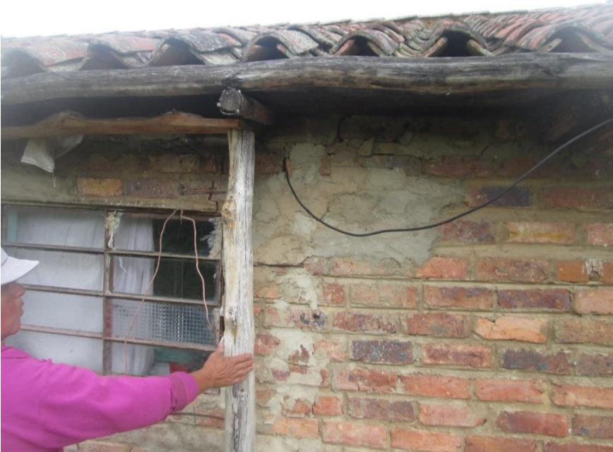
Figura 3-41. Grietas en fachadas.
