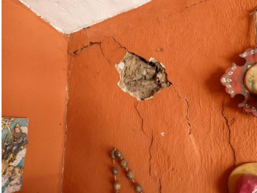
Figura 3-45. Grietas en casa de adobe.
