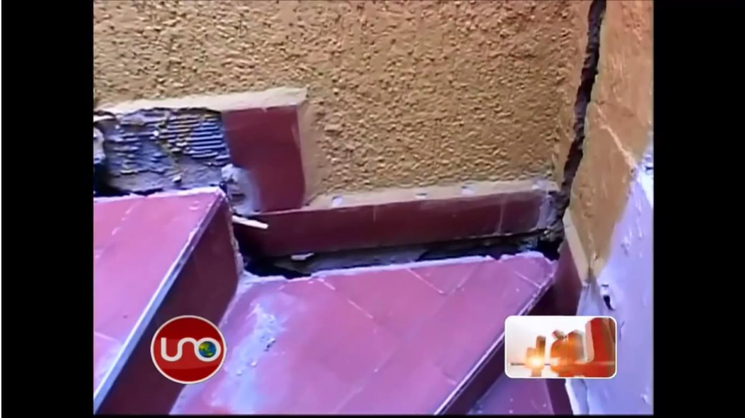
Figura 3-52. Daño en casas.
