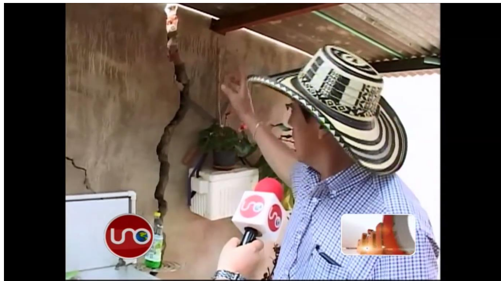
Figura 3-51. Grietas en viviendas urbanas.
