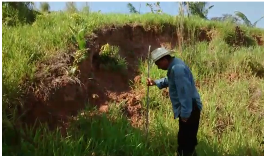
Figura 3-16. Derrumbes finca la Primavera.
