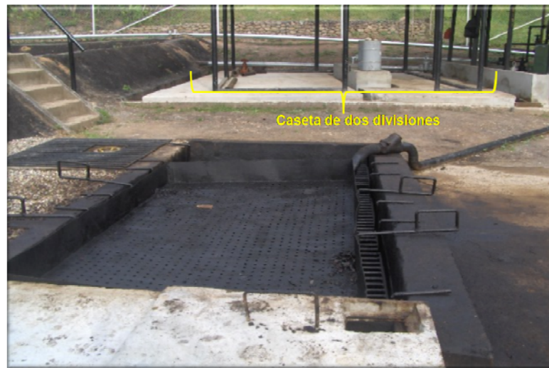
Figura 14. Caseta de dos divisiones ubicada en la estación del C.E.C
