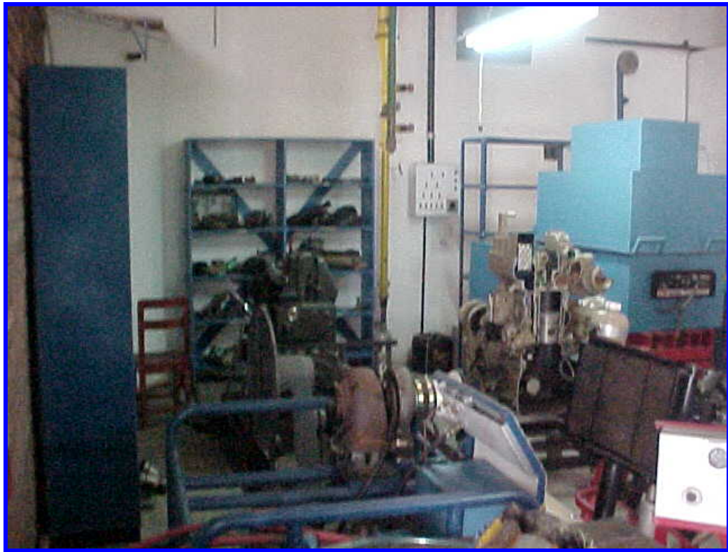
Fig. 1. Estado actual del laboratorio de maquinas térmicas alternativas.
