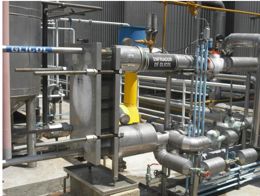
Figura 20. Enfriador de Glicol para cava de levadura cervecería de Bucaramanga
