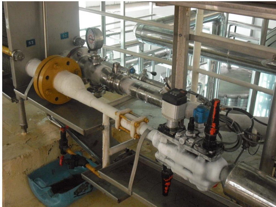
Figura 45. Ausencia de aislamiento en la tubería de entrada, Enfriador de cerveza madura
