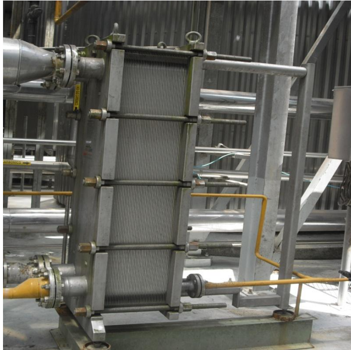
Figura 15. Enfriador de trasiego cervecería de Bucaramanga
