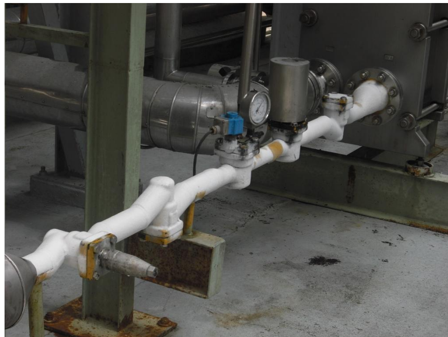
Figura 43. Ausencia de aislamiento en la tubería de entrada, Enfriador de trasiego
