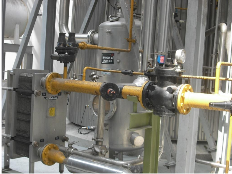
Figura 44. Ausencia de aislamiento en la tubería de salida, Enfriador de pony malta
