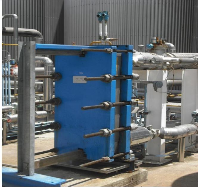
Figura 13. Enfriador de agua para mosto cervecería de Bucaramanga
