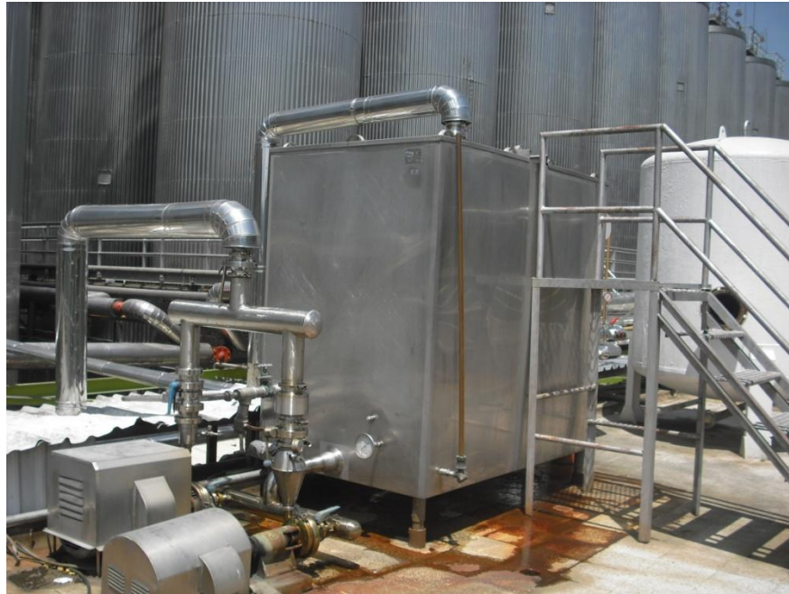
Figura 19. Enfriador de glicol para tanques BBT cervecería de Bucaramanga
