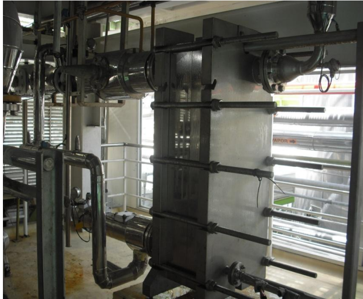
Figura 14. Enfriador de agua desaireada cervecería de Bucaramanga
