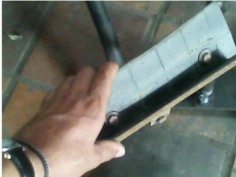
Figura . Pre ensamble de paletas de mezclado
