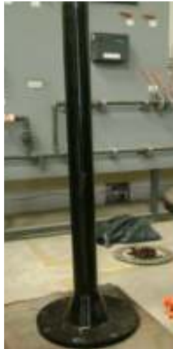
Figura 8. Chimenea de la minicaldera
