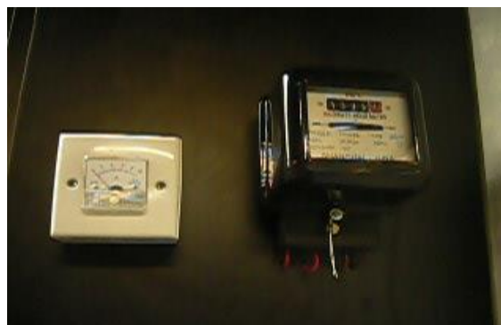
Figura 1. Contadores de potencia y corriente
