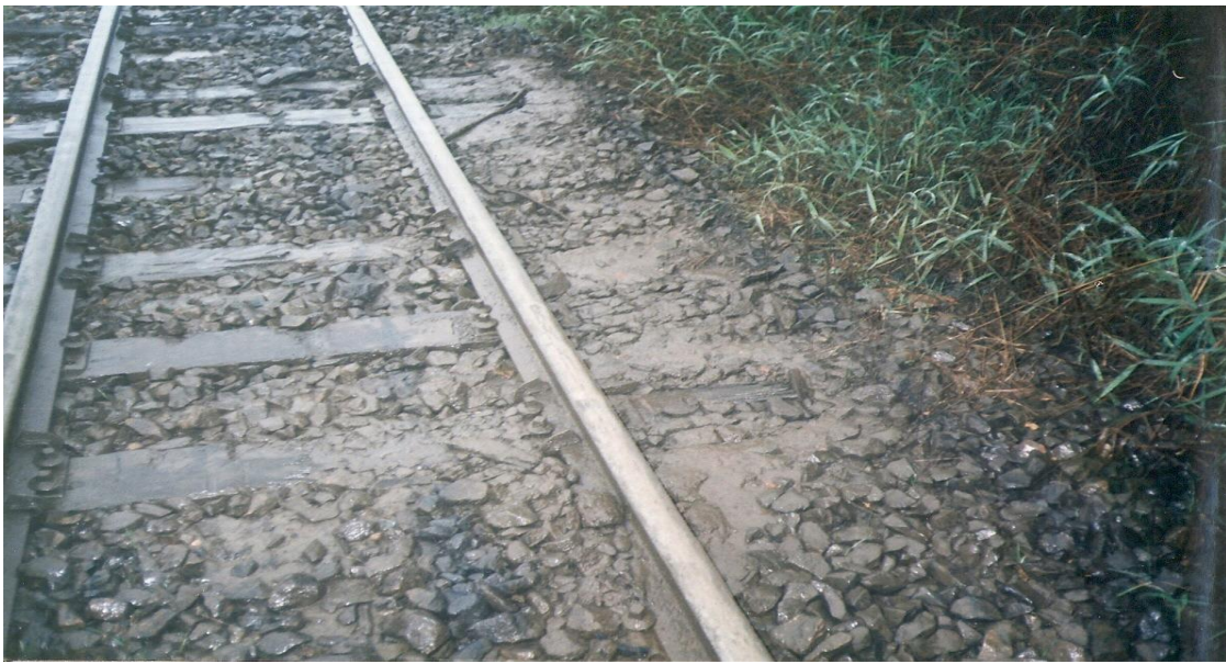
Figura 3. Lodos en balasto bajo condiciones deficientes de drenaje.
