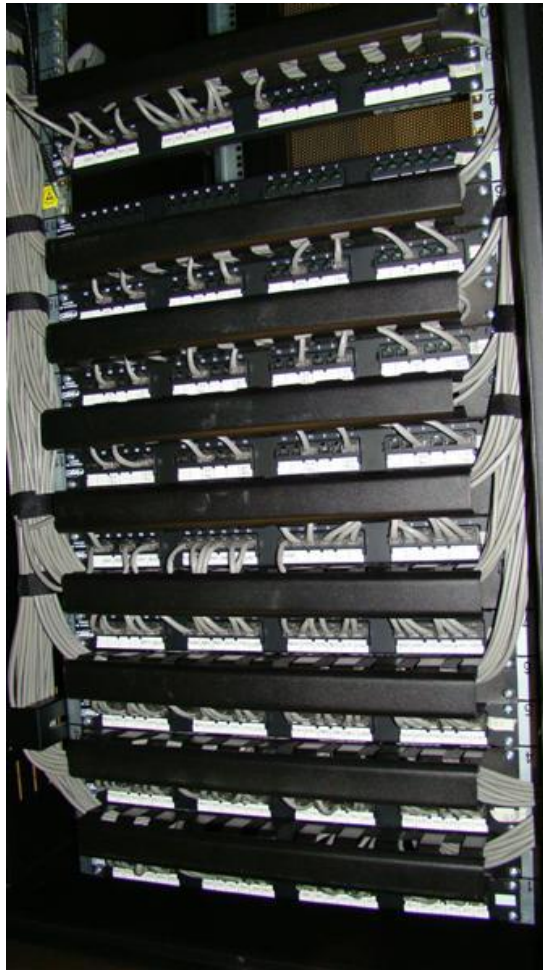
Figura 3.2 Rack de cableado 1
