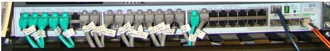
Figura 3.17 Foto Switch 3COM 4500G 24 puertos instalado actualmente 1 .
