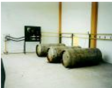
Figura 31: Sistema incompleto operación riesgosa. (Fuente CEPIS/OPS)
