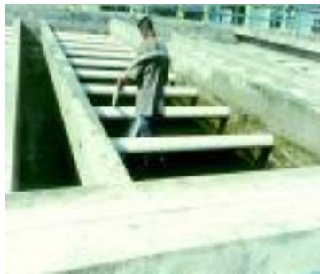
Figura 19: Operador parado sobre las pantallas de asbesto-cemento. (Fuente CEPIS/OPS)
