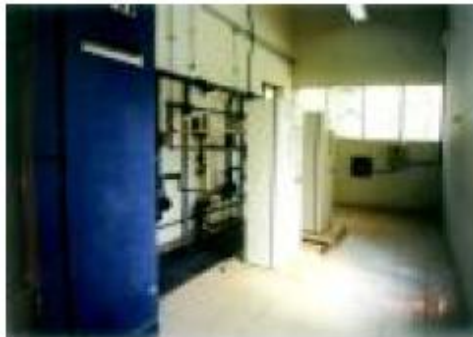
Figura 30: Sala de cloración con ventilación forzada. (Fuente CEPIS/OPS)
