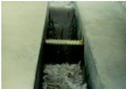
Figura 8: Mezclador tipo rampa operando correctamente. (Fuente CEPIS/OPS)
