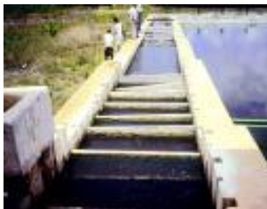
Figura 11: Defectos de operación y mantenimiento (Fuente CEPIS/OPS)
