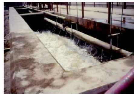
Figura 9: Mezclador hidráulico operando correctamente. (Fuente CEPIS/OPS)
