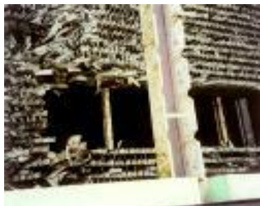
Figura 18: Módulos de plástico deteriorados. (Fuente CEPIS/OPS)
