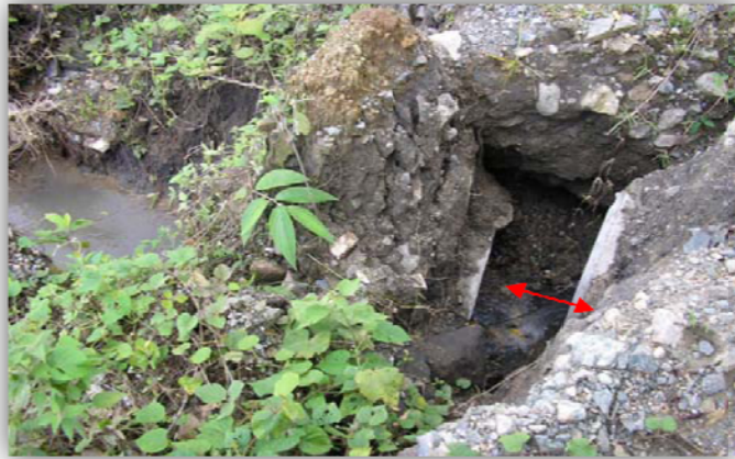
Figura 40. Separación de secciones de tubería permitiendo infiltración de agua (ST) Foto tomada del manual de INVIAS
