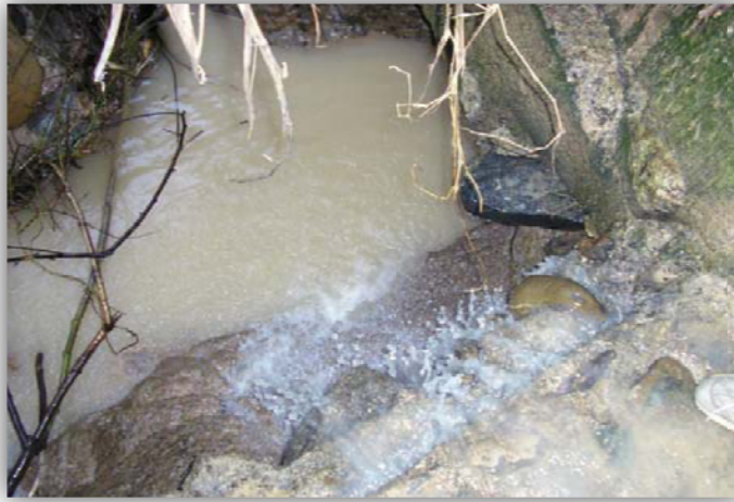
Figura 39. Grietas o Fracturamiento en canales disipadores y en otras estructuras que sirvan como encole o descole (GRI) Foto tomada del manual de INVIAS
