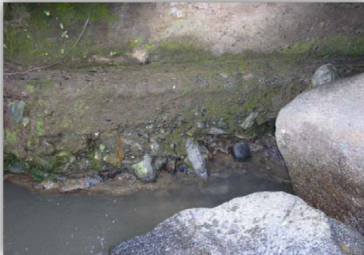
Figura 44. Socavación del concreto y suelo de fundación de aletas, solado, o muro cabezal (SO).
