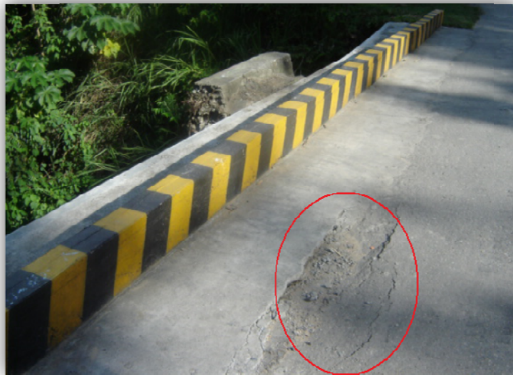
Figura 21. Desportillamiento de cuneta (DPT-DPL)-Foto tomada del manual de INVIAS
