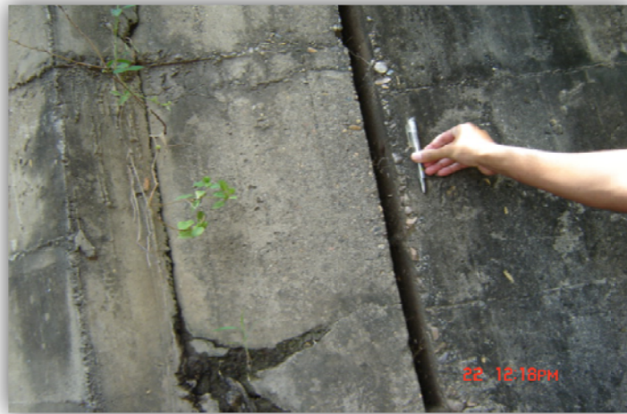
Figura 37. Grietas Verticales en la Unión entre Muro Cabezal y las Aletas (GV) Foto tomada del manual de INVIAS
