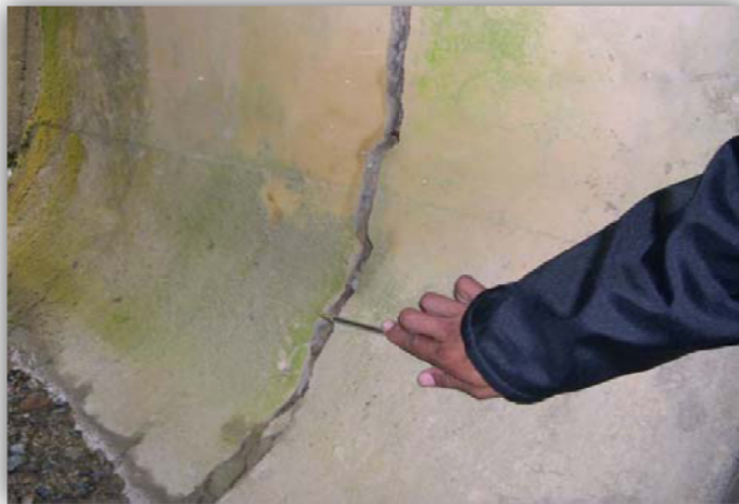
Figura 36. Grietas en Tubería Principal (GTP) Foto tomada del manual de INVIAS
