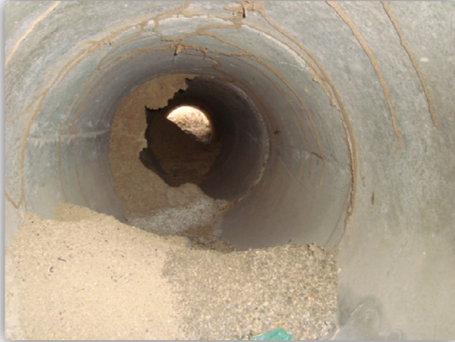
Figura 33. Tubería medianamente colmatada
