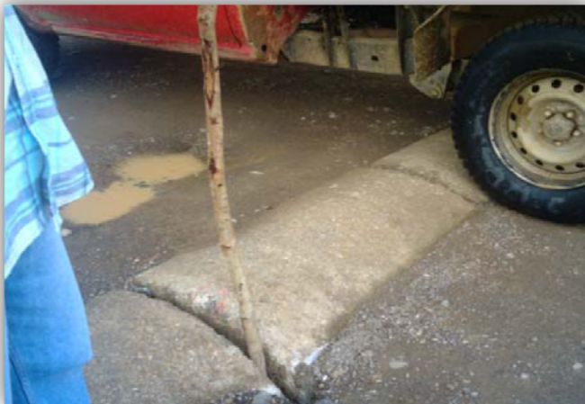
Figura 42. Exposición de la tubería a la acción del tráfico (ET) Foto tomada del manual de INVIA
