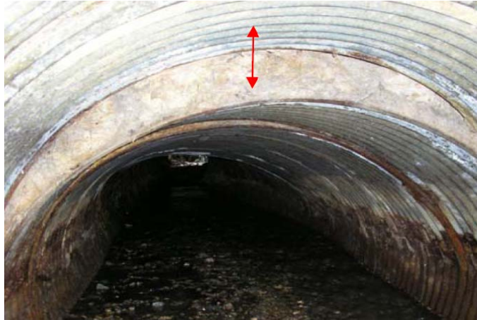
Figura 41. Hundimientos o aplastamientos de secciones de tubería (HU) Foto tomada del manual de INVIA
