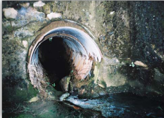
Figura 38. Fractura con pérdida parcial o total de la tubería (FT) Foto tomada del manual de INVIAS
