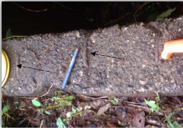
Figura 43. Exposición del acero de refuerzo en muro cabezal, aletas y tubería (EA) Foto tomada del manual de INVIAS
