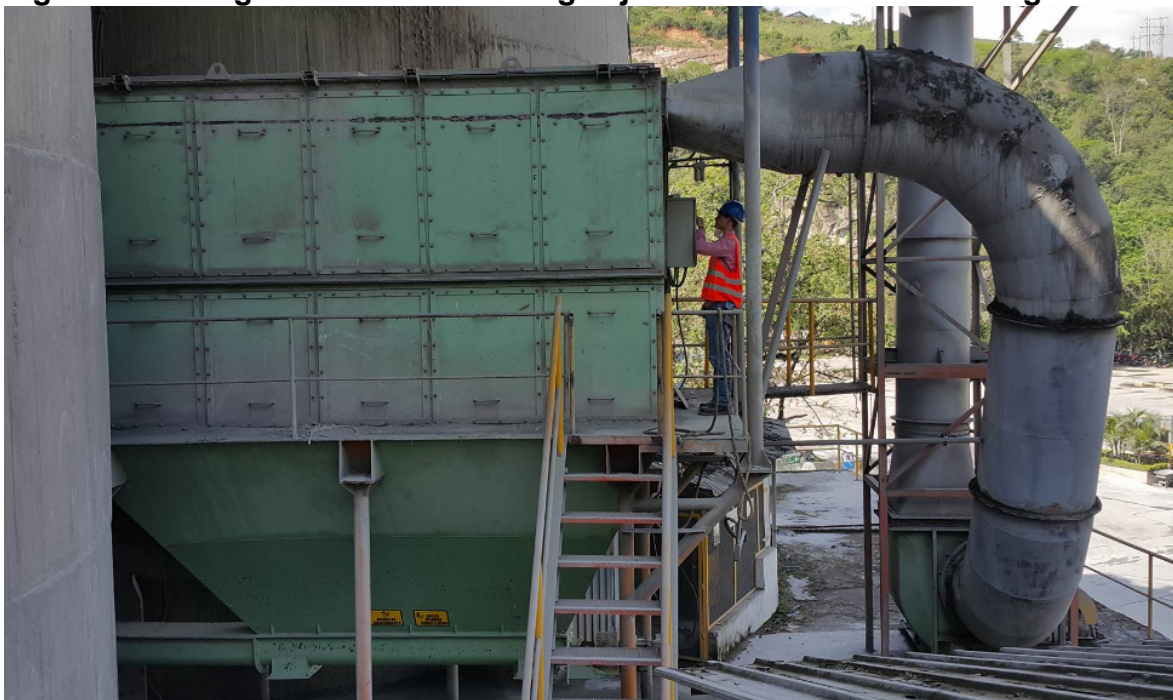
Figura 12. Fotografía del filtro de magas junto al ventilador centrifugo.
