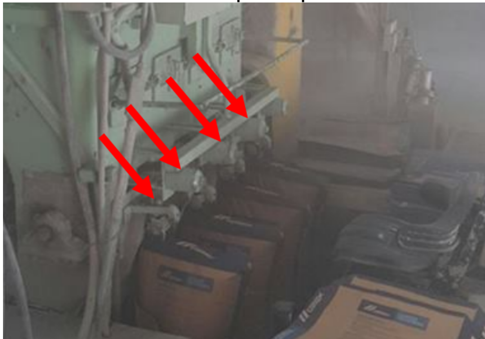
Figura 49. Tubos de llenado de la maquina empacadora 1.
