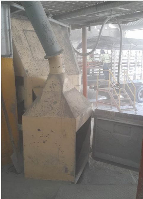
Figura 18. Campana tipo cabina (punto de medida 2).
