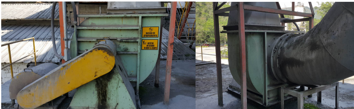
Figura 14. Fotografía del ventilador del filtro de mangas empaque.
