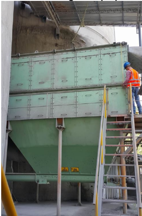
Figura 13. Fotografía del filtro de mangas empaque cemento.
