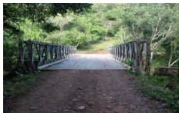
a) Calzada de lámina de acero lagrimada.
