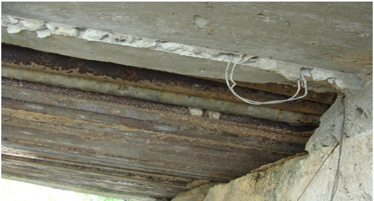
Figura 9. Parte inferior Box 1.
