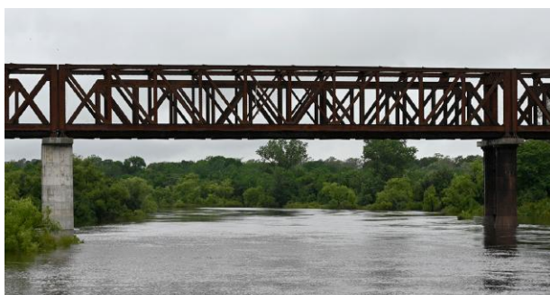
Fig. 28 – En esta imagen es visible una pila rigidizada, y una pila sin rigidizar. Las pilas existentes son mixtas: hormigón recubiertas en acero.
