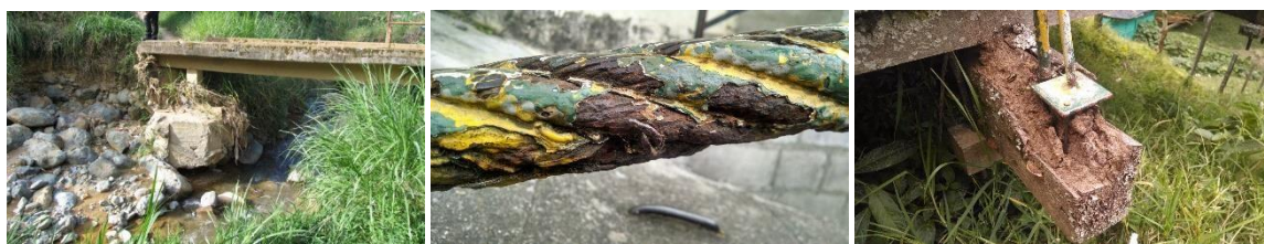
Fig. 3 – Daños ilustrativos en puentes de concreto, acero y madera, respectivamente.
