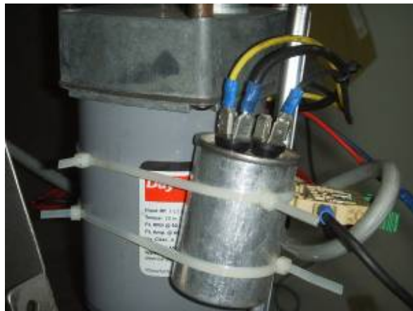
Figura 33. Ensamble eléctrico del prototipo
