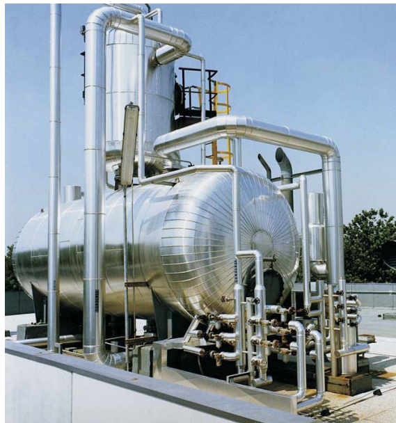
Figura 18. Sistema desaireador conformado por torre despojadora y tambor acumulador.
