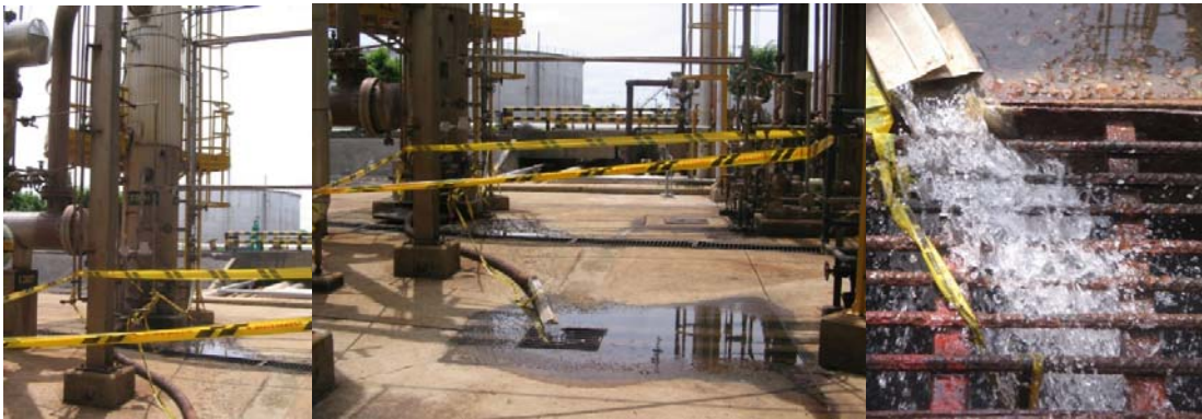
Figura 4. Condensado del D-2604 de la planta Hidrógeno
