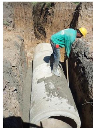
KM 4+900; KM 5+000 EXCAVACIONES VARIAS EN MATERIAL COMUN SECO, TUBERIA DE CONCRETO REFORZADO DE 900mm DE DIAMETRO INTERIOR, CONCRETO CLASE F (ALCANTARILLAS)
