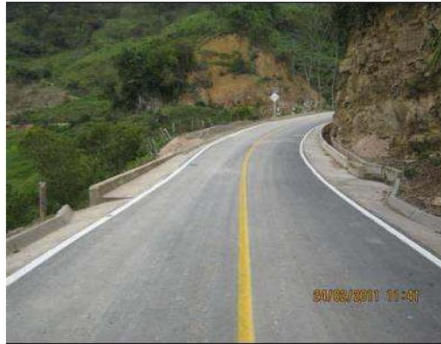
Foto No 9. Señalización horizontal en el k13+200
