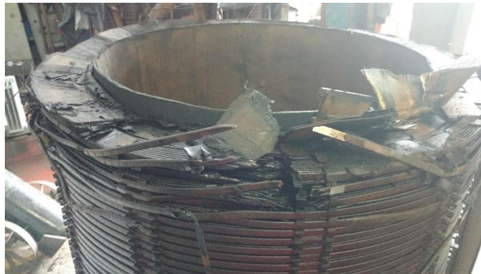
Figura 40. Bobina de alta tensión con circuito abierto por falla de descarga atmosférica.
