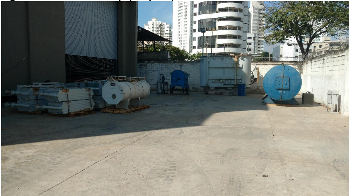
Figura 50. Ubicación de equipos para proceso en transformador de 20 MVA.
