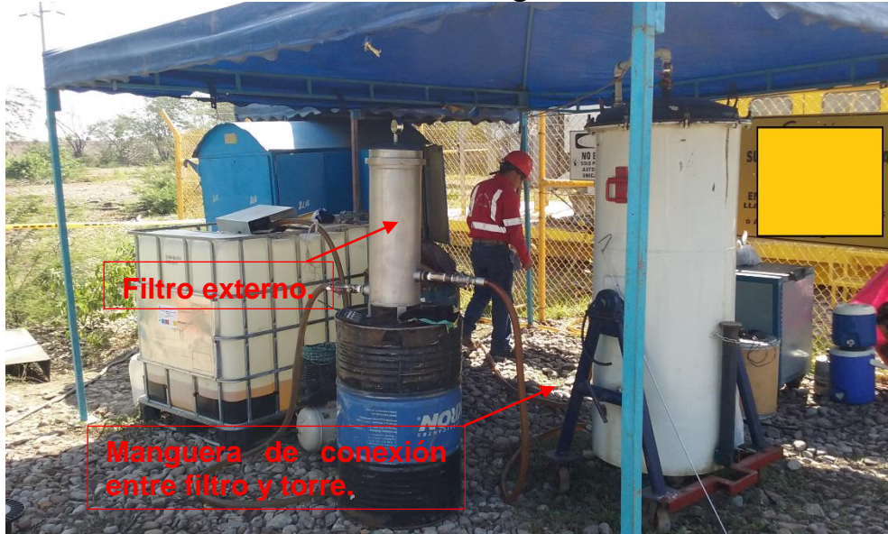
Figura 56. Conexión filtro con torre de regeneración
