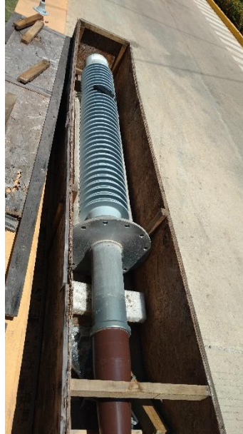
Figura 10. Buje de transformador 220 KV.
