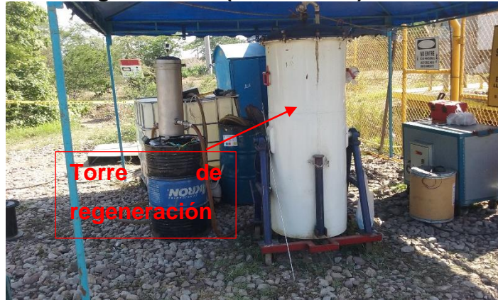
Figura 54. Torre de regeneración (Tierra fuller)
