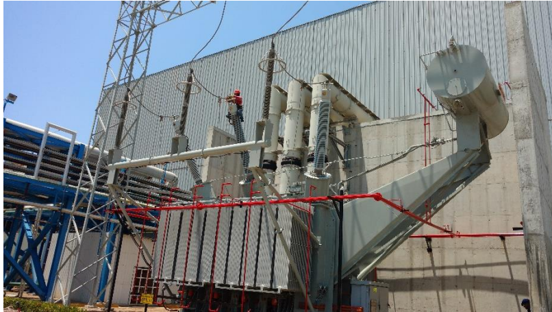
Figura 3. Transformador de potencia 220 MVA.
