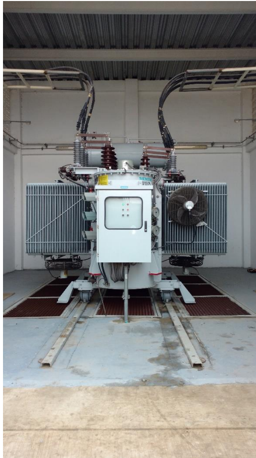
Figura 5. Transformador inmerso en aceite
