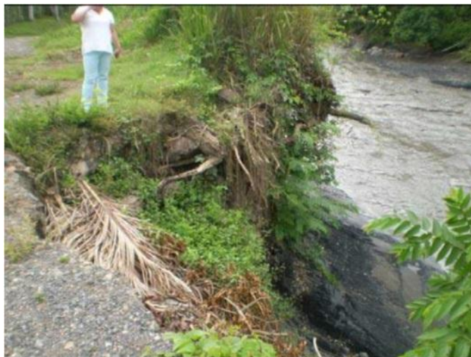
Figura 2. Falla de la ladera sobre el margen izquierda del río Villeta.
