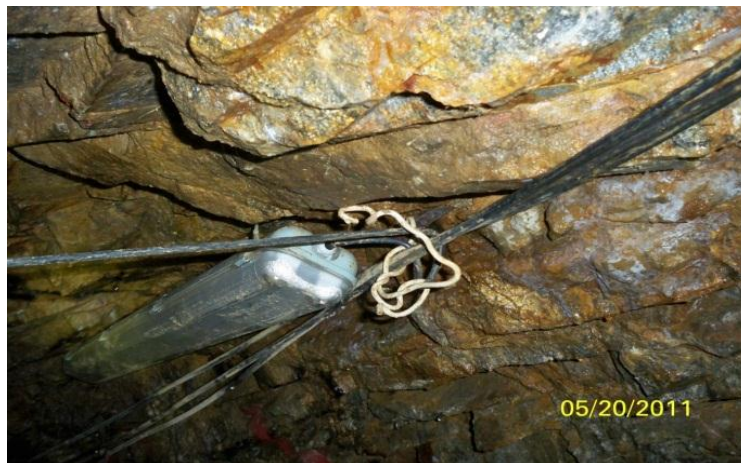
Figura 15. Alumbrado dispuesto para la mina.
