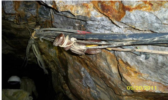
Figura 14. Soporte para el cableado que va hacia el interior de la mina
