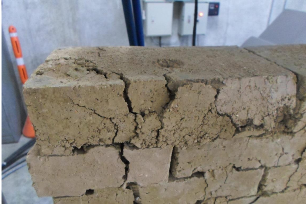
Figura 90. Detalle de falla hilada superior
