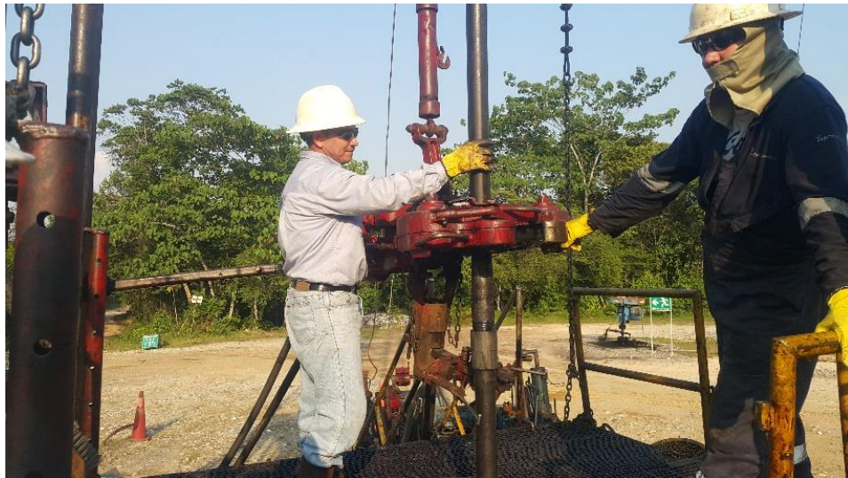
Figura 55. Set Up llave Hidráulica
