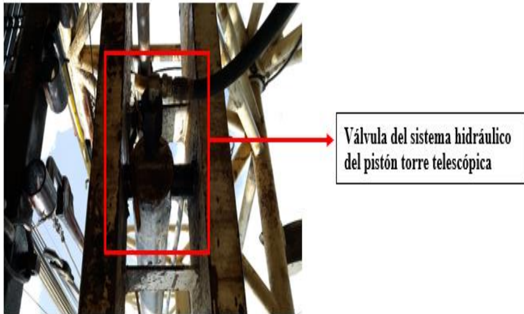
Figura 28. Válvula sistema hidráulico
