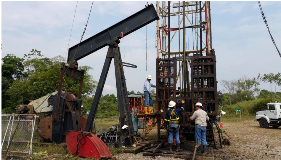
Figura 38. Unidad de bombeo Mecánico
