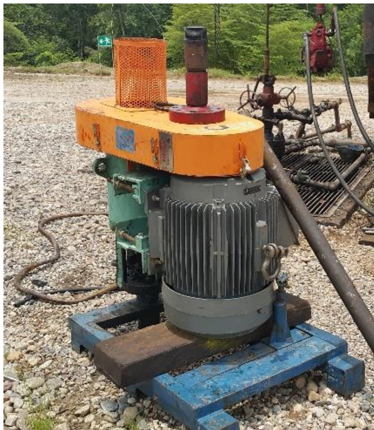
Figura 19. Base para cabezal de PCP.
