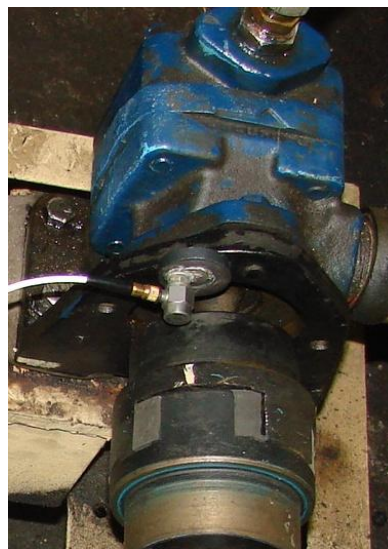
FIGURA 153 Montaje del sensor Piezoeléctrico en el punto 3 Axial del sistema de bombeo N°1
