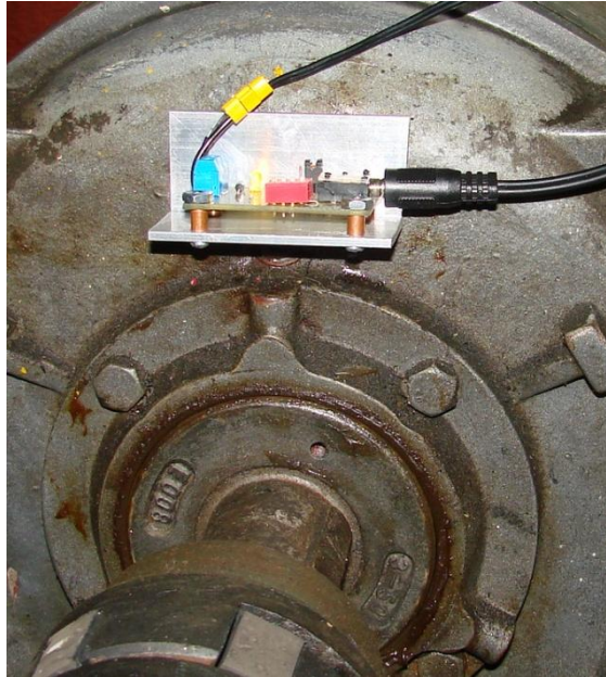
FIGURA 114 Montaje del sensor MEMS en el punto 2 Axial del sistema de bombeo 1
