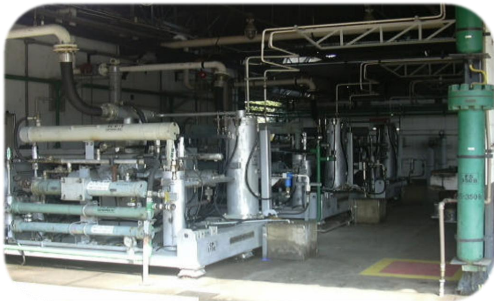
Figura 6. Compresores de hidrógeno
