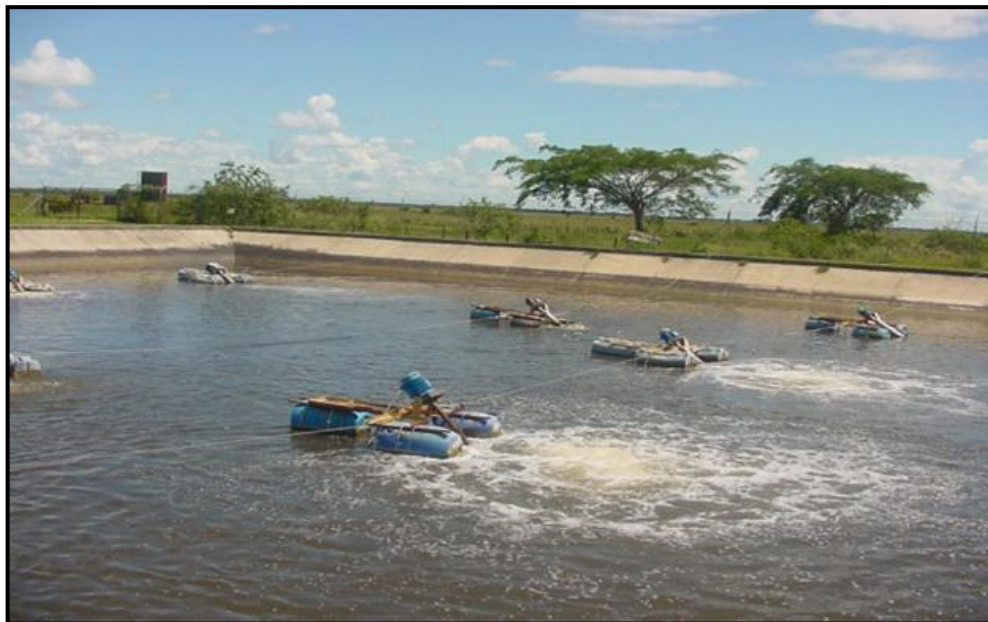
Figura 32. Piscina de Oxidación.
