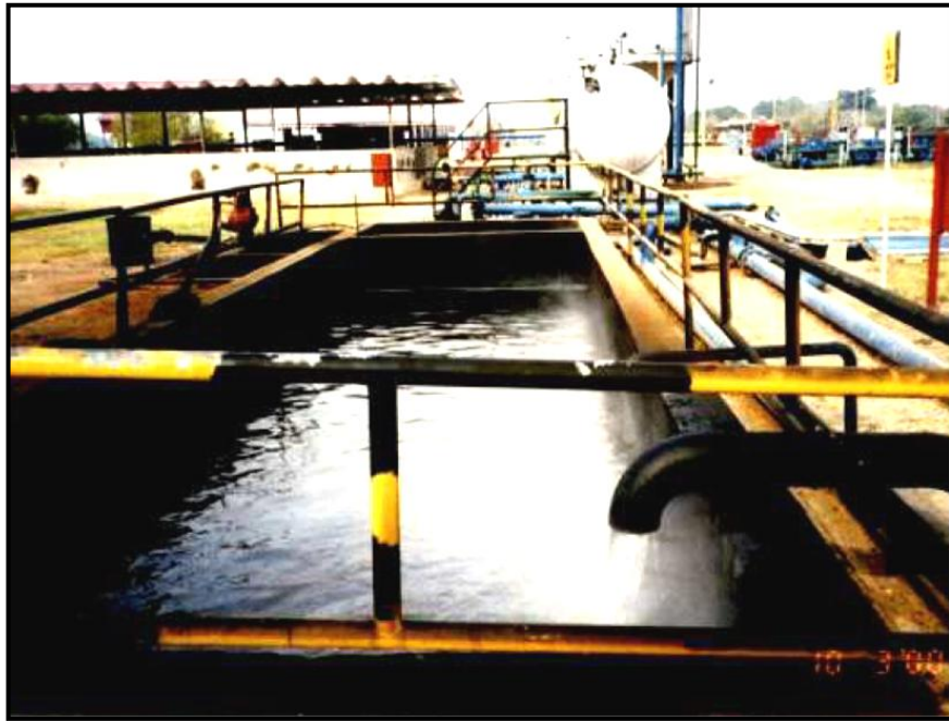
Figura 30. Caja API o separador API
