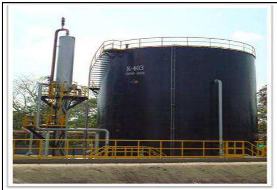
Figura 29. Tanque de Almacenamiento.
