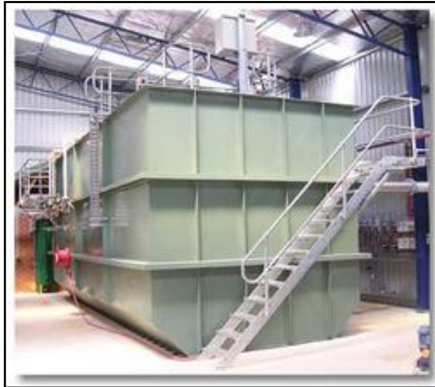
Figura 41. Equipo de flotación por aire disuelto
