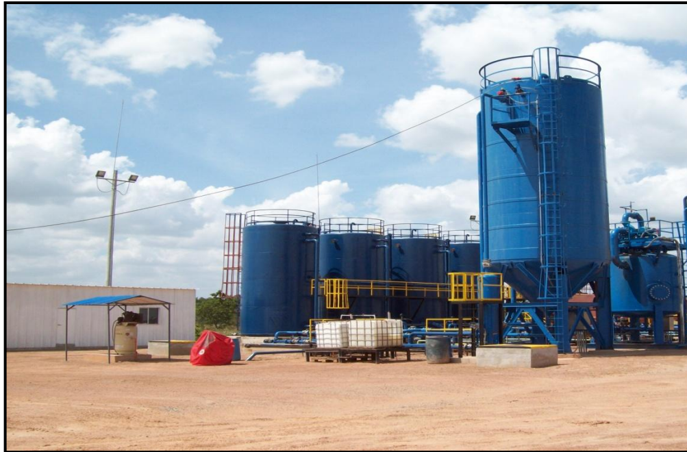
Figura 55. Planta de tratamiento campo Moriche
