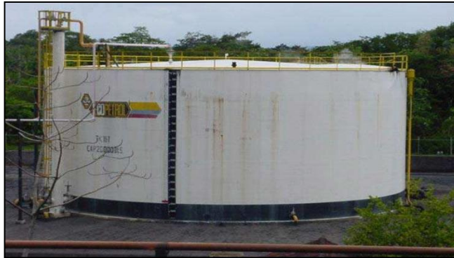
Figura 5. Tanque desnatador o Skim Tank
