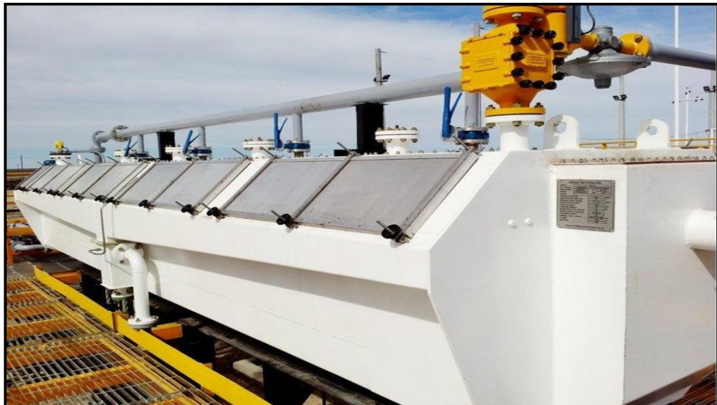
Figura 12. Unidad de Flotación Inducida por Gas.
