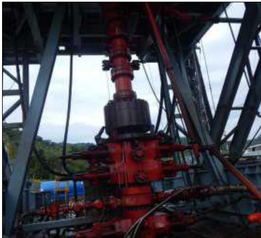
Figura 12. Válvula Preventora BOP.
