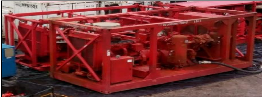
Figura 10. Booster utilizado en la operación de perforación con MPD para un pozo del piedemonte llanero.
