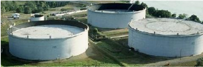
Figura 14. Tanques de Almacenamiento de Crudo Cilíndricos con Techo Flotante.
