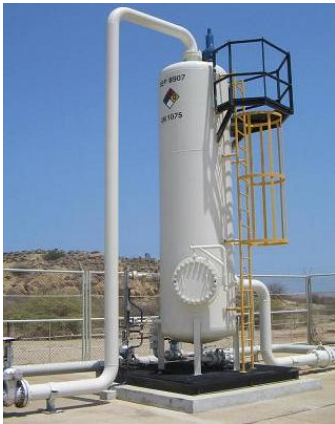
Figura 10. Separador Vertical de Crudo.
