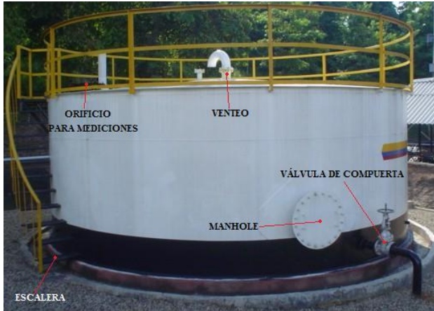
Figura 15. Accesorios de un Tanque de Almacenamiento de Crudo Cilíndrico.
