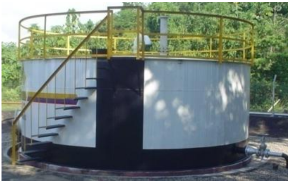
Figura 13. Tanque de Almacenamiento de Crudo Cilíndrico con Techo Cónico Fijo.
