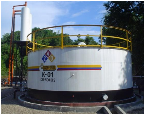
Figura 89. Uno de los Dos Tanques de Almacenamiento de la Batería de Recolección de Campo Colorado.
