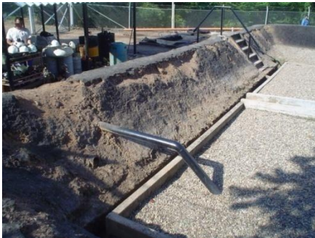
Figura 16. Diques alrededor de un Tanque de Almacenamiento.
