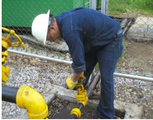
Figura 61. Cierre válvula de compuerta línea de flujo
