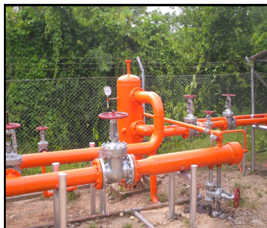
Figura 11. Sistema de control y tratamiento del gas CEC
