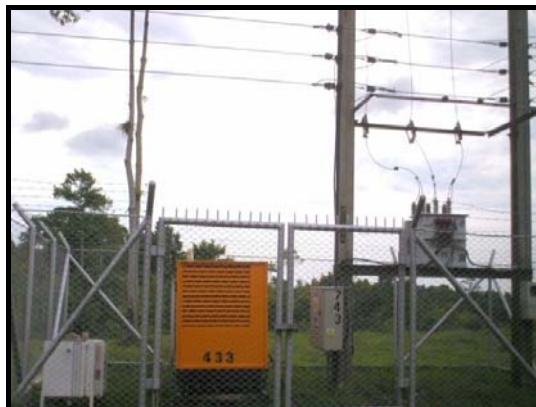
Figura 57. Planta eléctrica Campo Colorado
