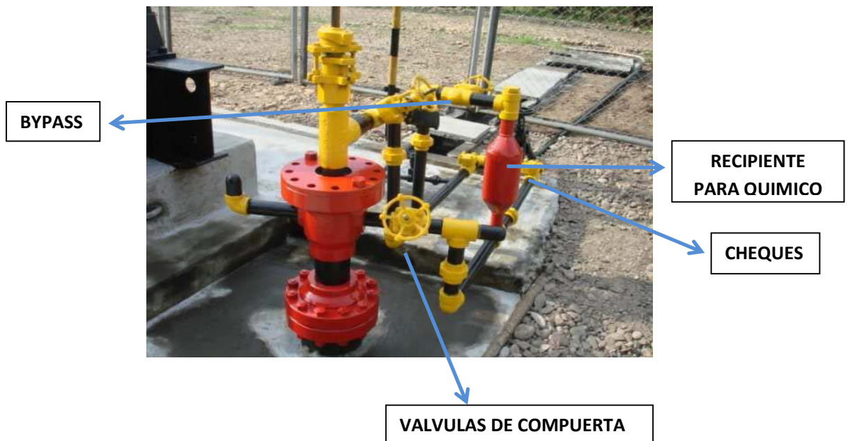
Figura 60. Componentes del sistema de recirculación de químico CEC.
