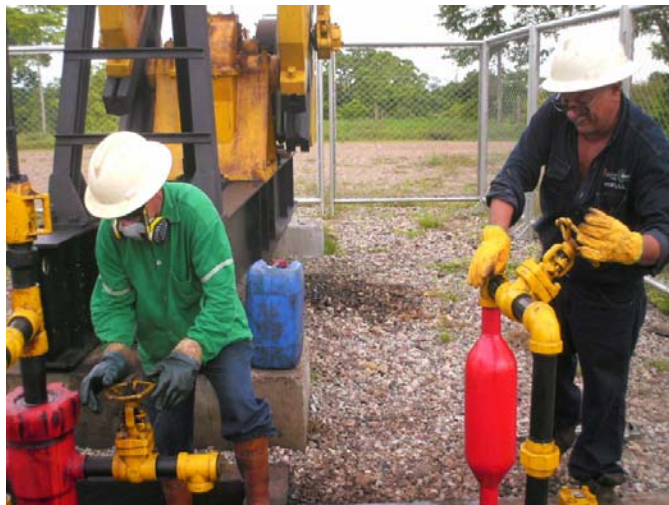
Figura 65. Cierre de las válvulas bypass del recipiente y del anular.
