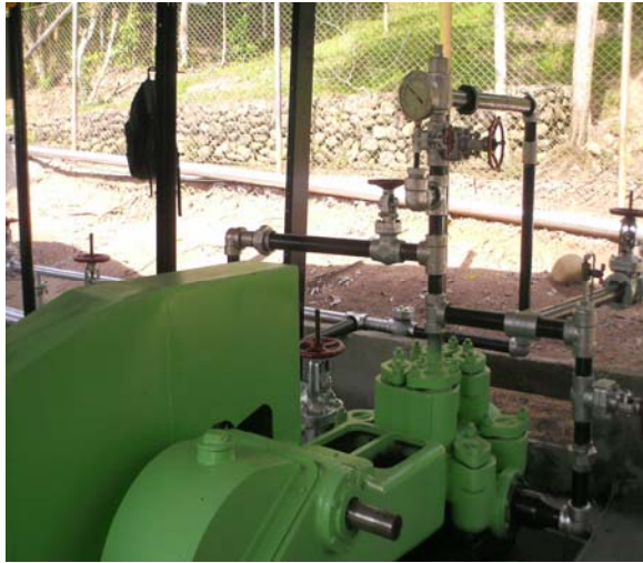
Figura 6. Bomba de transferencia de crudo
