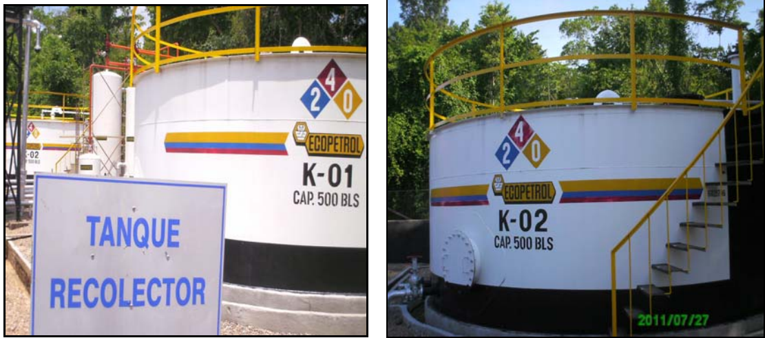
Figura 8. Tanques de almacenamiento de crudo
