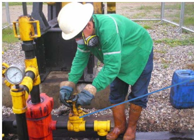
Figura 64. Apertura de la válvula del anular
