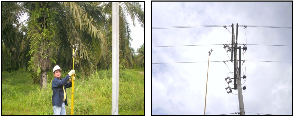
Figura 58. Pórtico (casajera) central eléctrico
