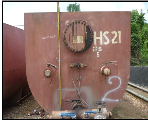
Figura 10. Tanque de almacenamiento auxiliares
